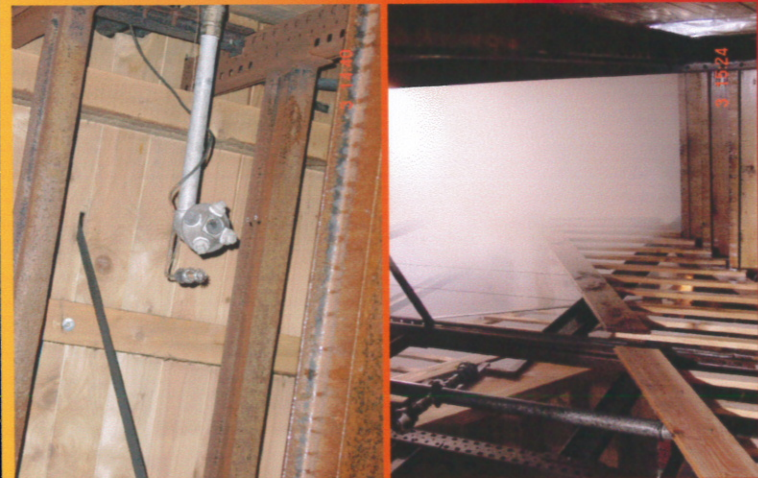
Vertikaler Sprühkopf mit 1 Zentraldüse und Indikator-sprinkler unter Podest 3 - Sprühversuch ohne Brand
