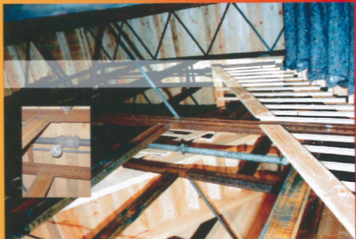
Rechtes Sprührohr über sämtliche Etagen
