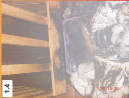
Brandschäden an der Vorderseite des Geländers (Foto 1.4) und an der Lagerbox (Foto 1.5)
