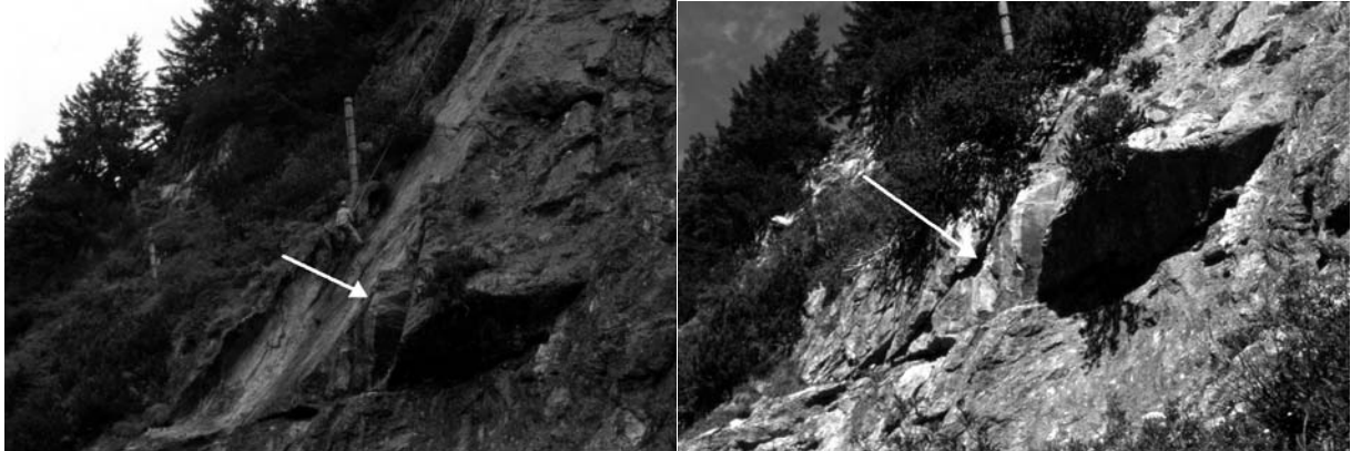
Abb. 7-10: Links: Begehung der frischen Abrissfläche des Felssturzes an der B197. Die Bundesstraße befindet sich direkt unterhalb des Bildausschnittes. Rechts: Ausbiss der Kluftfläche (Pfeil) vor dem Ereignis (Photos M. Fulde).
