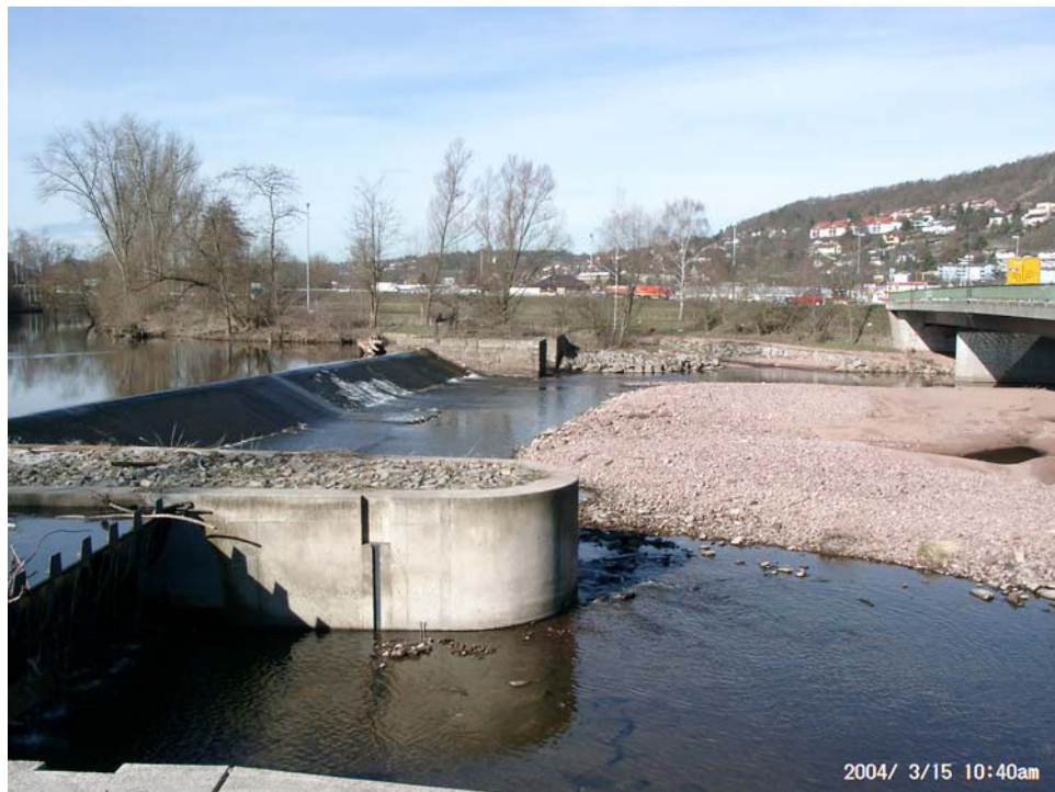
Abb. 3.30: Anlandung von Feststoffen im Bereich einer Gerinneaufweitung unterhalb einer Wehranlage bei Niefern/Enz ca. drei Kilometer unterhalb der Untersuchungsstrecke Pforzheim/Enz. (Aufnahme: Lehmann)
