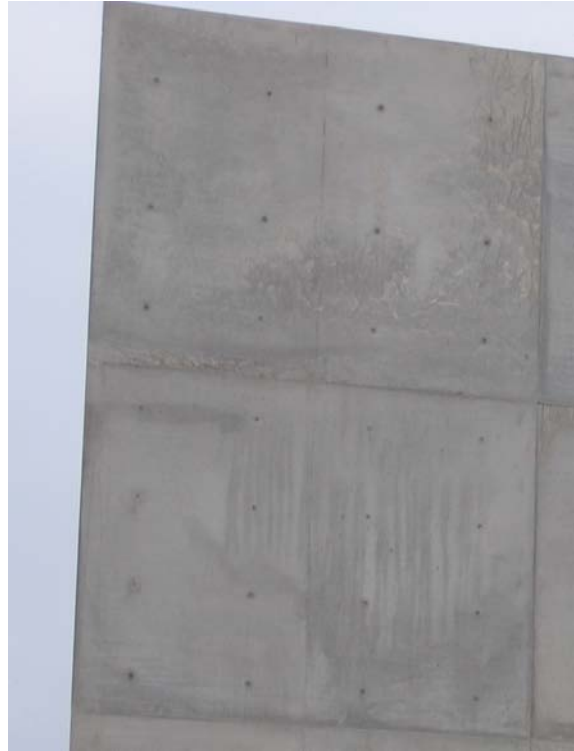
Abb.: 3: Wand in SVB mit lokalen Problemstellen
