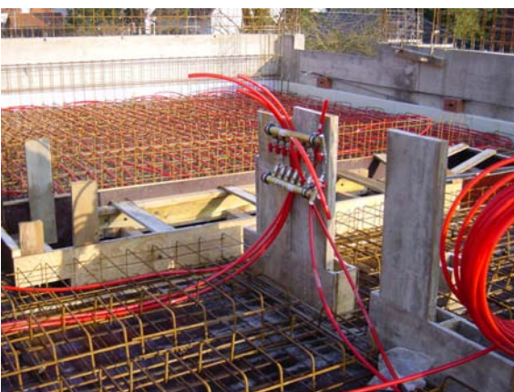
Abb. 20: Haus S: Betonkerntemperierung EG-Decke
