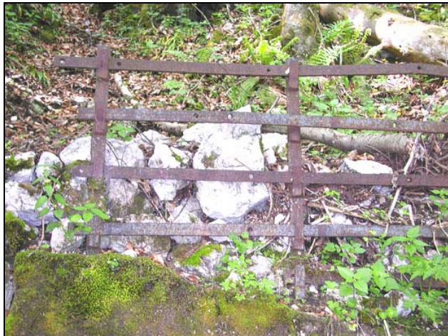
Foto 8.2-1: Verfülltes Steinschlaggitter älterer Bauart im Bereich der Hallstätter Hanglagen (2003).
