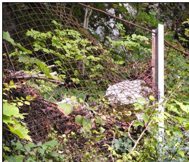
Foto 9.4-1: Veraltetes Steinschlagnetz oberhalb der Häuser von Hallstatt(2003).
