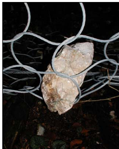
Foto 9.4-2: Steinschlagnetz mit Schlingen (2003).
