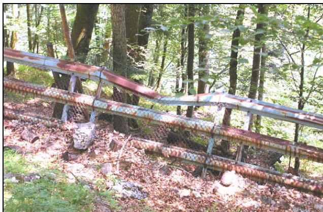
Foto 8.2-2: Kombinierte Verbauung über Hallstatt. Schneebücke mit Fangzaun, die jedoch schon ein größeres Steinschlagereignis hinter sich hat.
