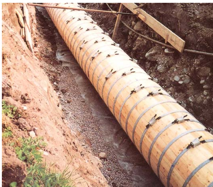
Bild 1-4 Druckrohrleitung aus Holz (a) auf Sättel und (b) im Graben verlegt (von Canbar Inc., Zwick Holzbau GmbH)
