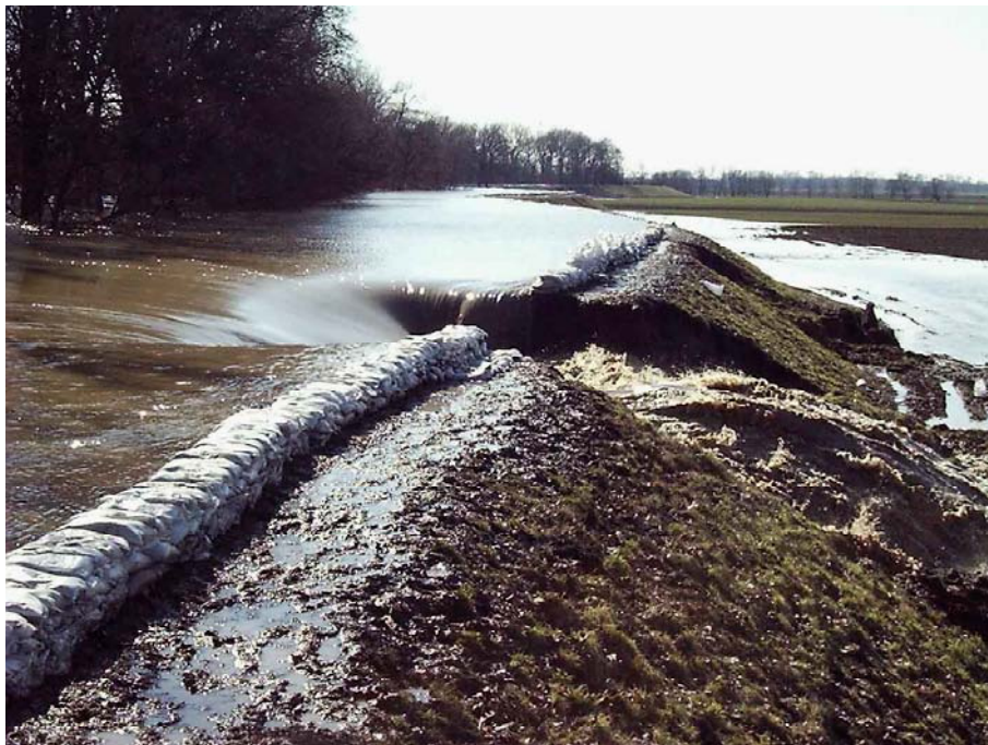
Abb. 2.13 Deichbruch an der Theiß/Ungarn im März 2001 (Foto: Szlávik 2001)
