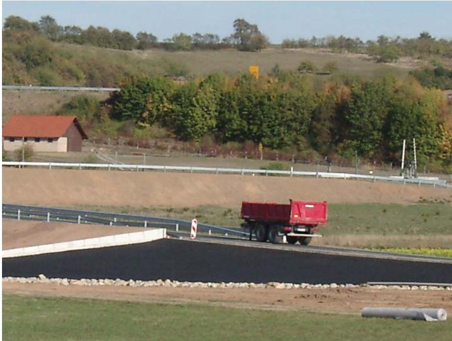
Abb. 3.15 Ausführungsbeispiel einer Dammscharte mit einem Deckwerk aus Mastix-Schotter am Hochwasserrückhaltebecken Im Bödighheimer Tal der Stadt Buchen vor der Begrünung (Foto: Bernhart 2003)
