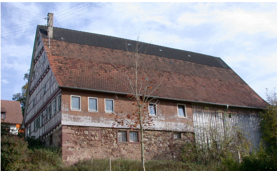
Abb. 28: Beispiel Schopfloch-Unteriflingen: Seit ca. 30 Jahren leerstehendes Wohn-Stallhaus in Fachwerkbauweise; eigene Aufnahme
