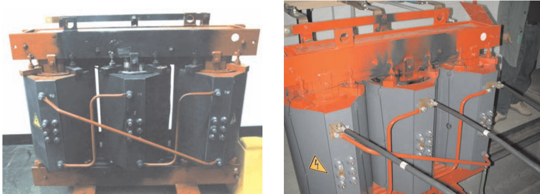
Abb. 16. Transformatorschaden ohne und mit Temperaturüberwachung.
