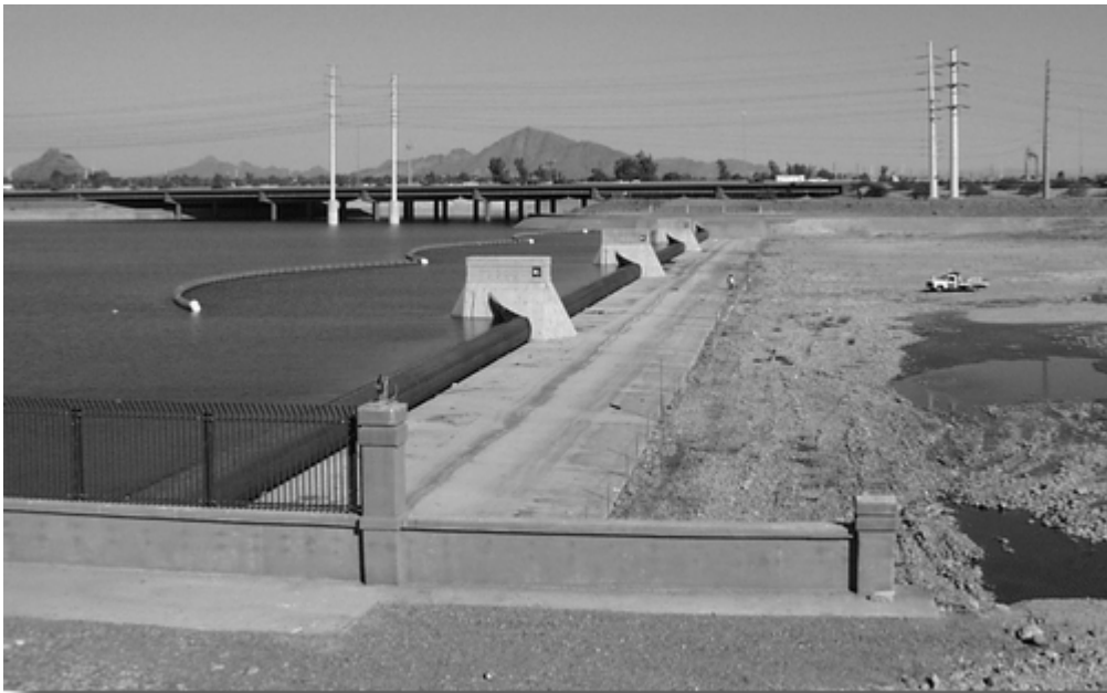
Abbildung 2.5: Luftgefülltes Schlauchwehr am Tempe Town Lake, USA (Schlauchhöhe 4,90 m, 4 Wehrfelder à 73,15 m, Inbetriebnahme 1989)
