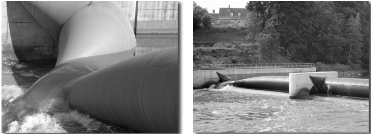
Abbildung 2.15: Einknicken bei luftgefüllten Schlauchwehren
