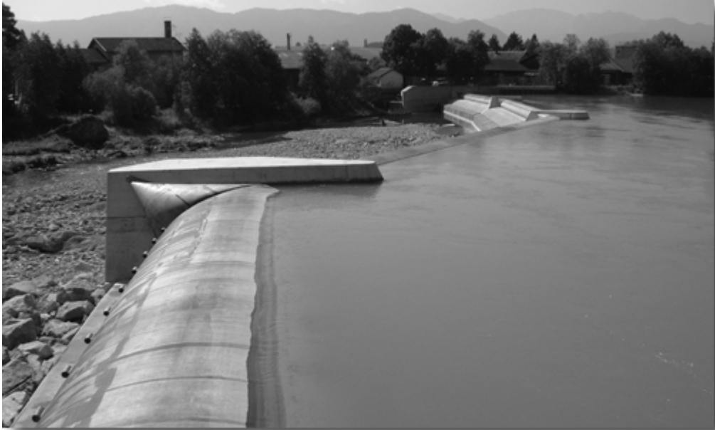
Abbildung 2.8: Wassergefülltes Schlauchwehr in Lechbruck, Deutschland (Schlauchhöhe 3,15 m, 3 Wehrfelder à 24,80 m und 1 Wehrfeld à 45,80 m, Inbetriebnahme 2001)
