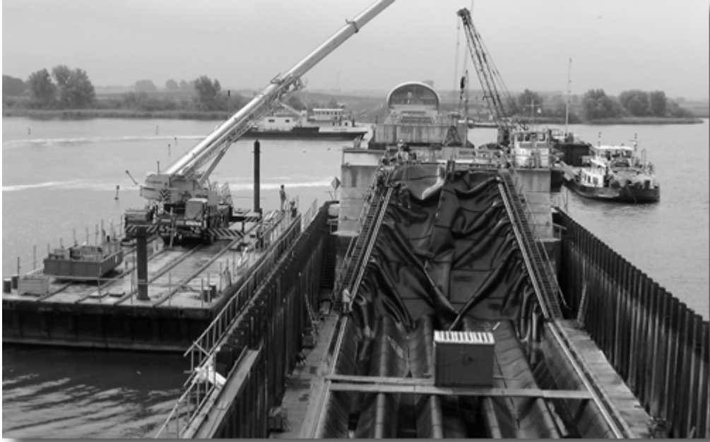
Abbildung 2.3: Wasser- und luftgefülltes Schlauchwehr in Ramspol/Overijssel, Niederlande (Schlauchhöhe 8,35 m, 3 Wehrfelder à 75,00 m, Inbetriebnahme 2001)
