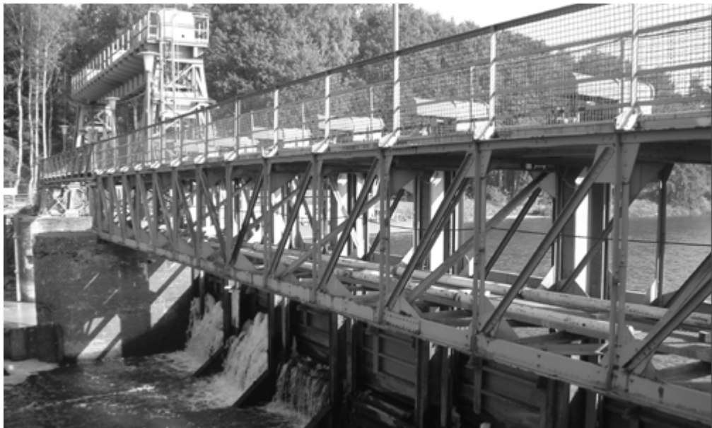
Abbildung 8.1: Staustufe Marklendorf an der Aller, Ansicht vom Unterwasser auf den Wehrsteg und die Hakendoppelschütze
