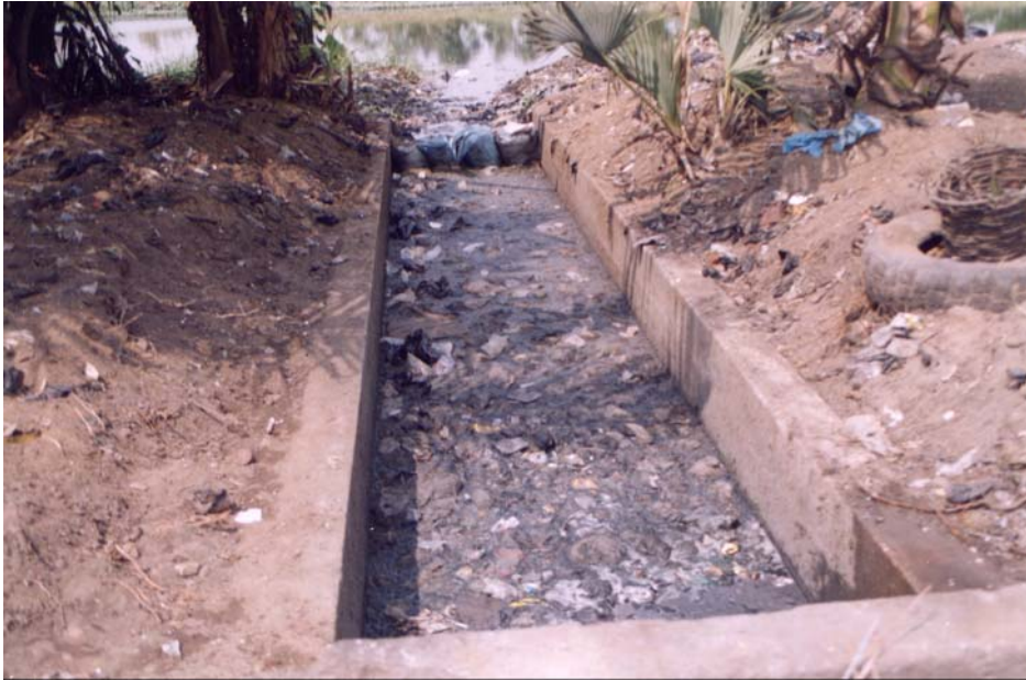
Foto 9: Müllentsorgung in einem Regenwasserkanal im Stadtteil Amoutivé (2005)
