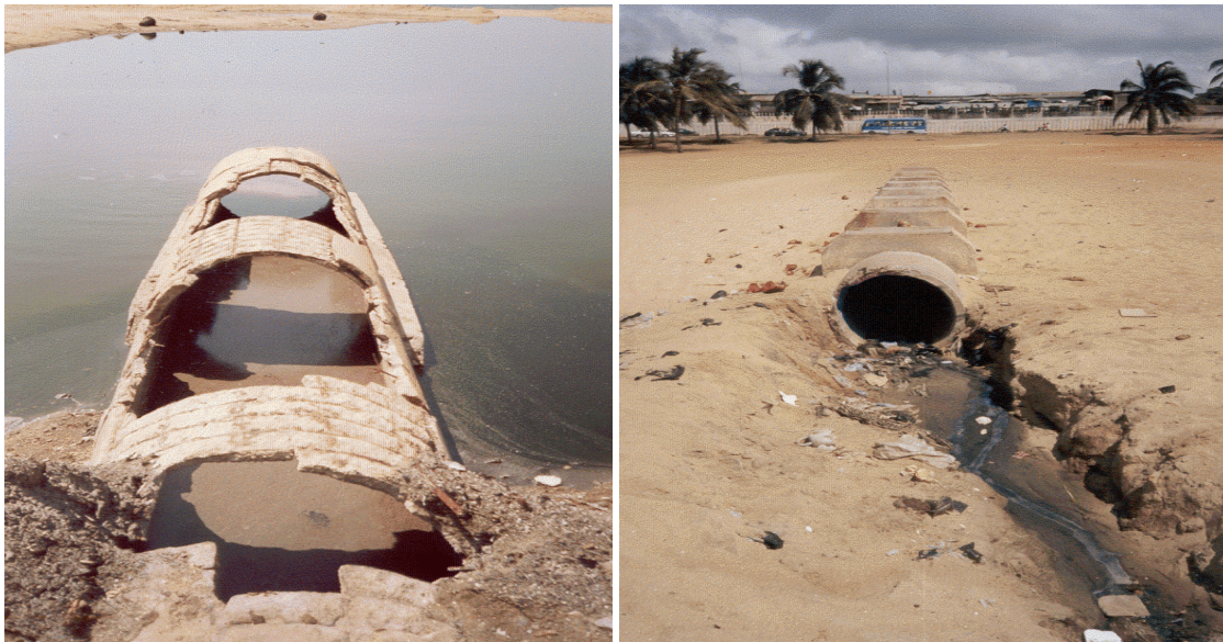
Foto 8: Beschädigter Abwassereinlauf ins Meer und in den Strand
