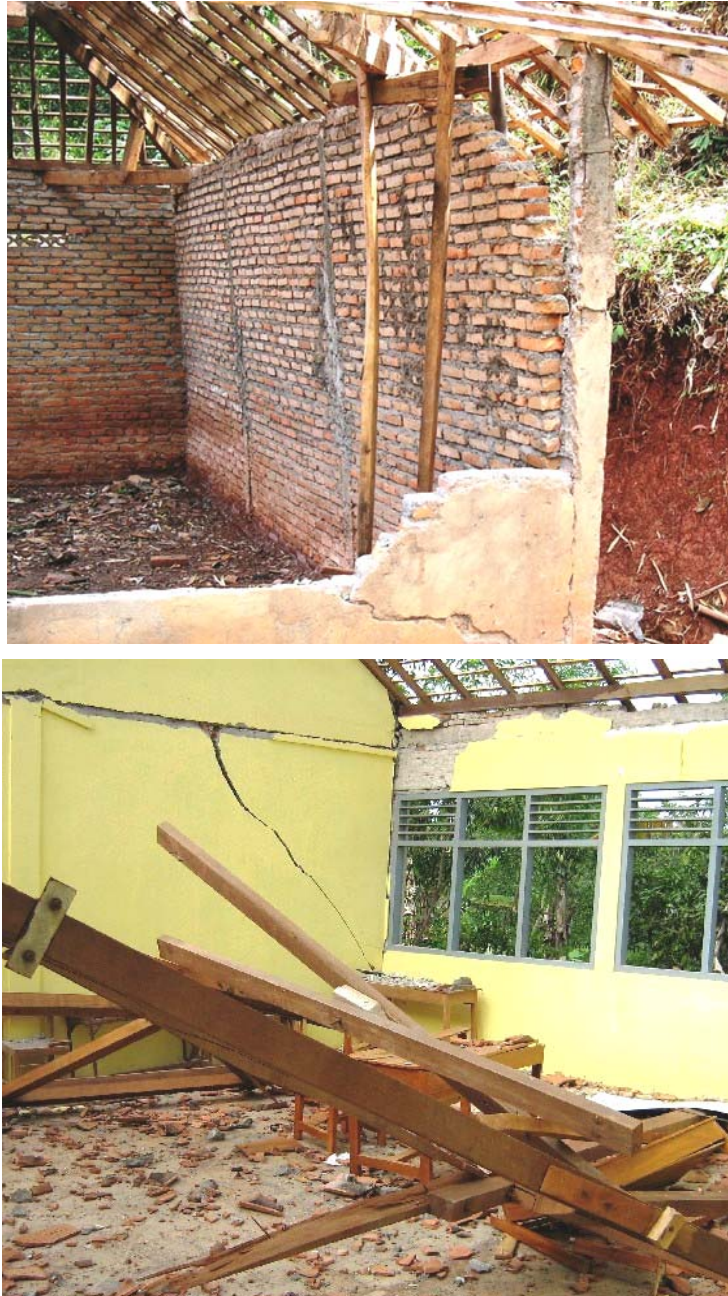
Bild 4-15 a) fehlender Ringanker und b) mangelhafte Dachaussteifung
