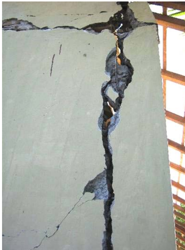
Bild 7-2 Schadensursachen: mangelnde Aussteifung und fehlerhafte Anschlüsse
