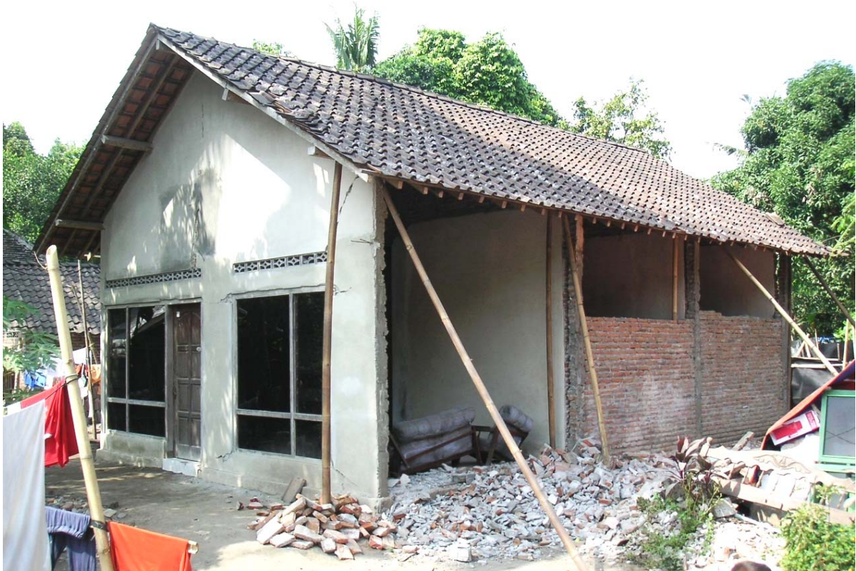
Bild 4-16 kollabierte Wandscheibe (Mauerwerk)
