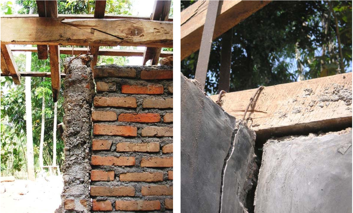
Bild 4-17 fehlender Anschluss von Mauerwerk und Stahlbetonstütze
