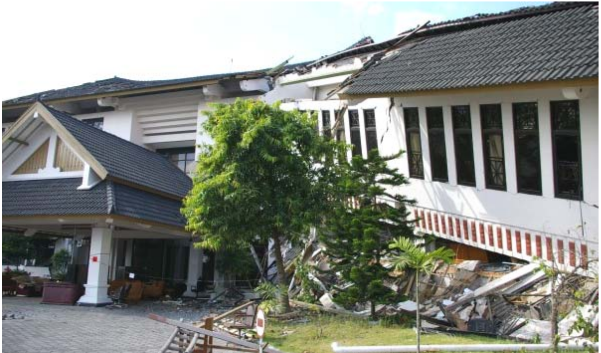
Bild 4-7 Seitenansicht mit eingestürztem Bereich
