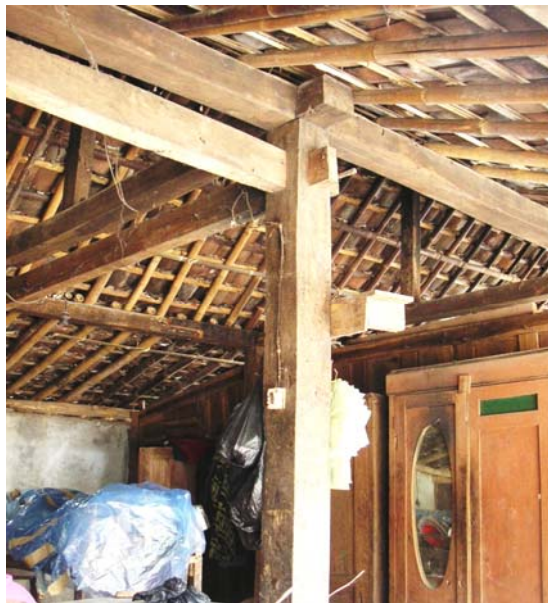
Bild 5-2 Gebäude ohne Erdbebenschäden: a) Mischkonstruktion unter Berücksichtigung von Regeln für erdbebensicheres Bauen; b) reine Holzkonstruktion
