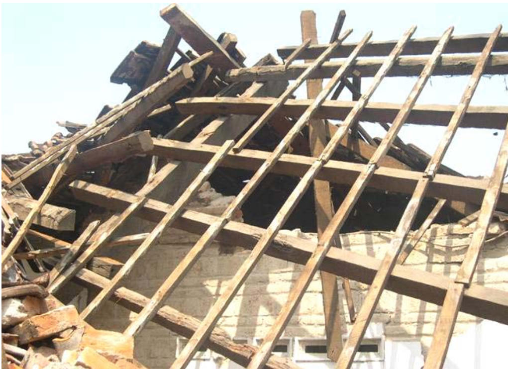
Bild 4-9 zerstörte nicht-ingenieurmäßig errichtete Gebäude in ländlichen Gebieten
