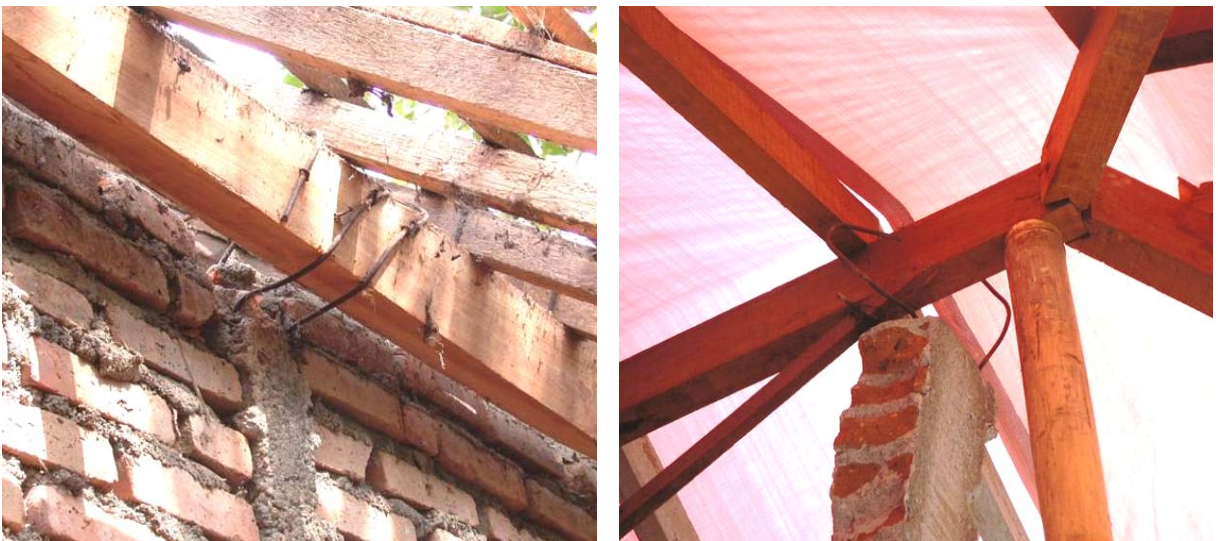
Bild 4-18 mangelhafter Anschluss von Dachkonstruktion und Wand / Stütze
