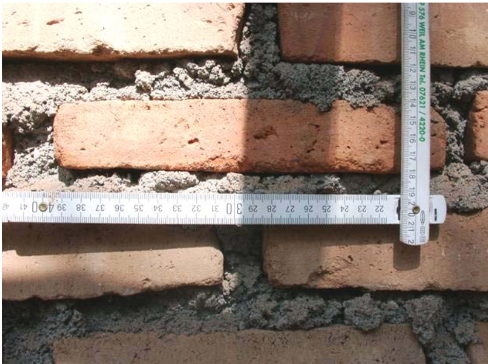
Bild 4-21 a) Mauerwerk mit geringer Qualität und b) schlechter Ausführung
