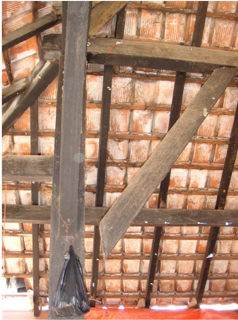
Bild 4-19 Beispiel für mangelhafte bauliche Durchbildung von Verbindungen
