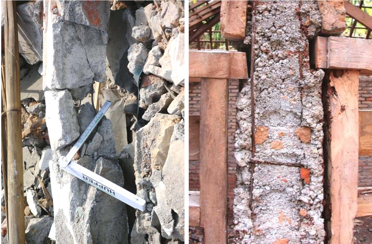
Bild 4-20 a) Versagensdetail einer Stütze und b) mangelhaft ausgeführte Stütze
