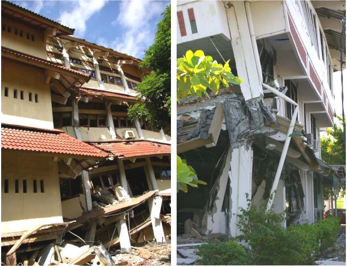
Bild 4-6 Stützenversagen (Ausknicken der Bewehrung)
