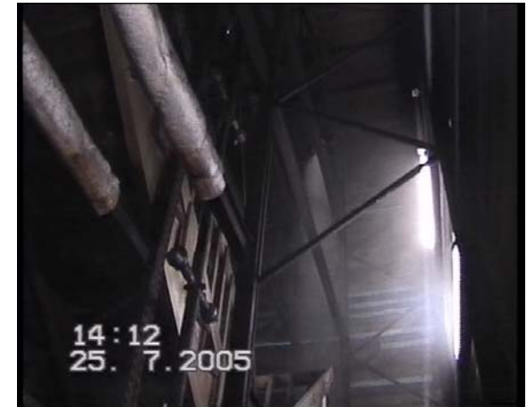
Einzeldüse im Treppenraum 135 bar
