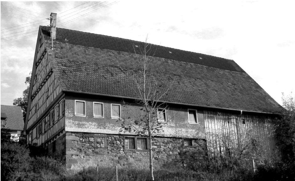
Abb. 28: Beispiel Schopfloch-Unterfilingen: Seit ca. 30 Jahren leerstehendes Wohn-Stallhaus in Fachwerkbauweise; eigene Aufnahme
