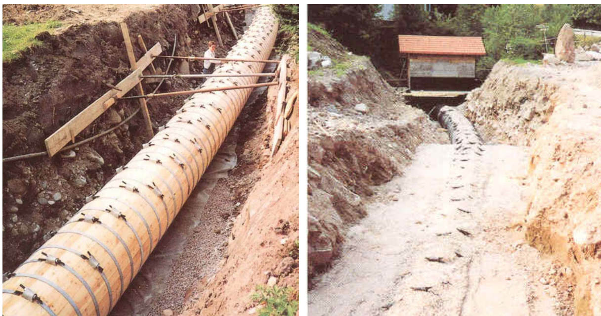
Bild 6-7 erdverlegte Druckrohrleitung aus Holz (von Zwick Holzbau GmbH)
