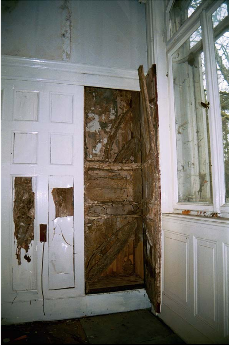
114: Villa Amann, Speisezimmer (R20), ehemaliger Speiseaufzug ins Obergeschoß integriert in die Wandvertäfelung.
