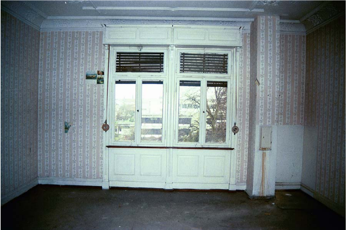
139: Villa Amann, Erstes Gästezimmer (R28) nach Süden. Das auf dem Bild sichtbare Heizungsrohr rechts des Fensters wurde nach 1945 eingebaut.
