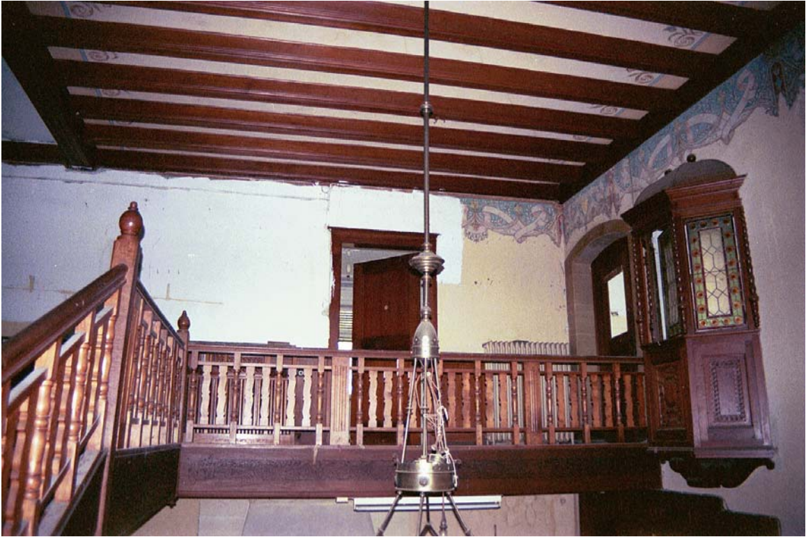
227: Villa Amann, Galerie der Halle (R17c). Die Wandmalereien sind zum großen Teil mit Dispersionsfarbe überstrichen und nur im westlichen Bereich erhalten, da dort die Farbe ausgegangen war. Aufnahme vor der Restaurierung, 2000.
