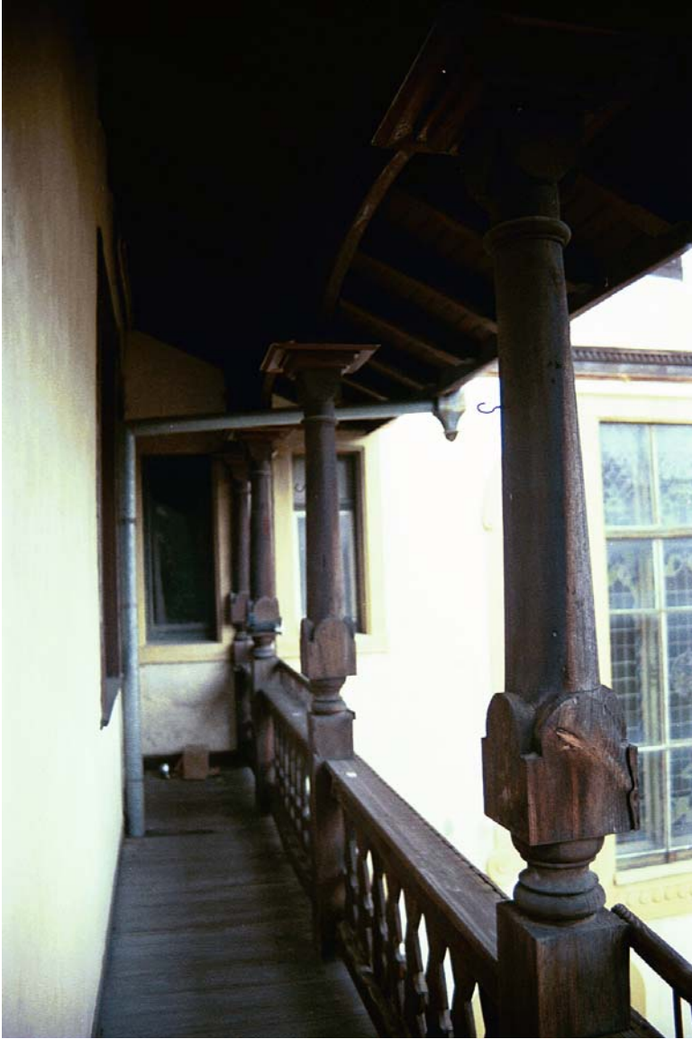
50: Villa Amann, Nordseite, Blick von der Galerie des Küchentraktes auf das fast verdeckte Obergeschoßfenster des Dienerschaftstreppehauses.
