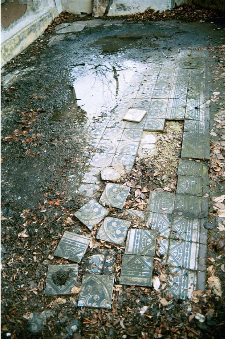
42: Villa Amann, Terrakottafußboden der südlichen Erdgeschoßterrasse, Zustand 2000.
