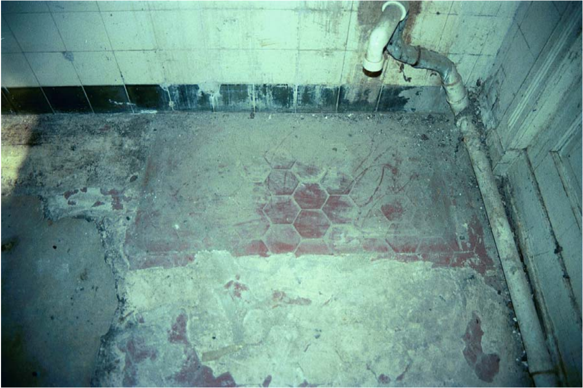
151: Villa Amann, Privater Baderaum (R32), Reste der sechseckigen Terrakottafliesen des Originalfußbodens.
