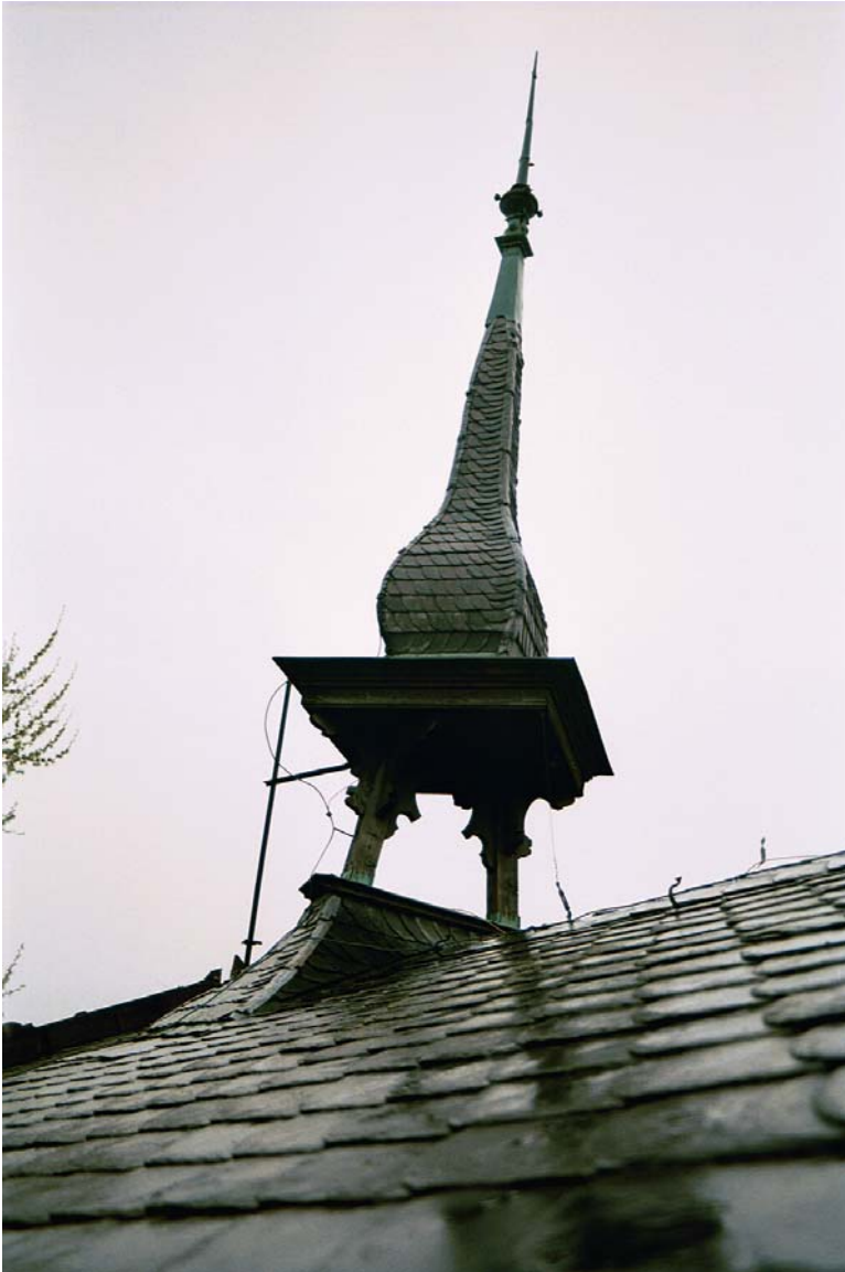
47: Villa Amann, Dachreiter, sog. Glockentürmchen. Es ist ein reines Zierstück ohne jegliche Funktion, das nie eine Glocke besaß. Zustand vor der Restaurierung 2001.
