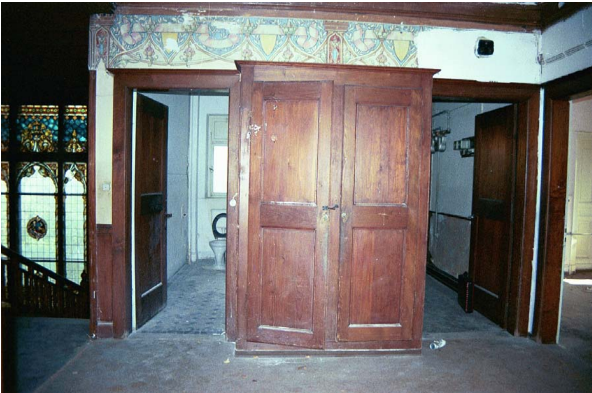
126: Villa Amann, oberer Flurbereich der Halle (R17c), Nordwand mit Wandschrank und Zugänge zur oberen Toilette (R35) und rechts zum oberen Nebenflur (R34).
