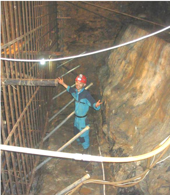
Abb. 25: Blick in den Gründungsbereich der Sperrmauer mit oberstromigem Kofferdamm (rechts), Bewehrung der Mauer (links) und Rohren zur späteren Kontaktinjektion zwischen Beton und Fels
