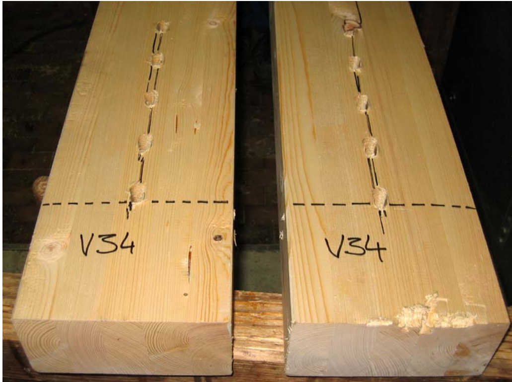
Bild 3-4 Verstärktes Bauteilende mit Rissen im Bereich der Stabdübel
