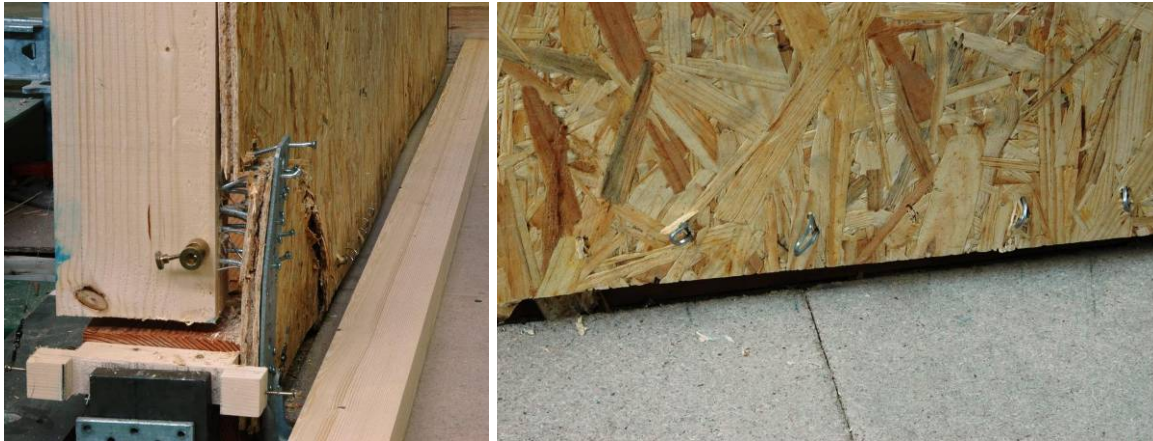
Bild 5-34 Fundamentwinkel mit ausgezogenen Verbindungsmitteln, Lockerung der Beplankung an Schwelle (links), ausgezogene Klammern an der Schwelle (rechts)
