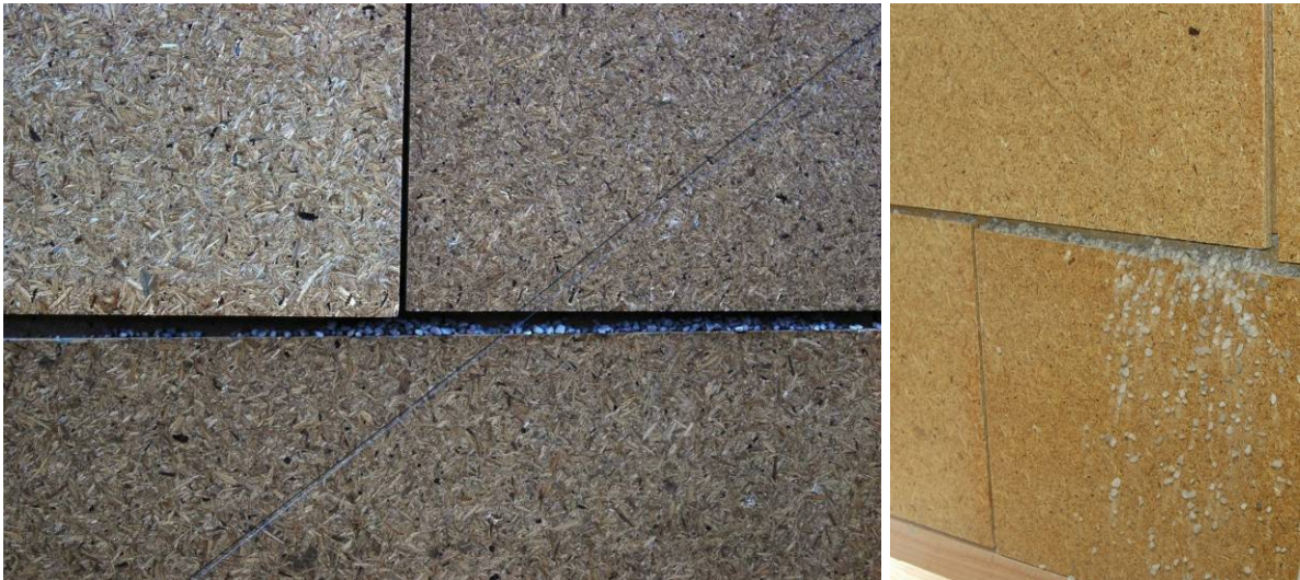
Bild 5-29: Blockieren der Fuge durch eingeklemmte Flusskiesel (links), Ausrieseln der Flusskiesel bei höheren Verschiebungen (rechts)
