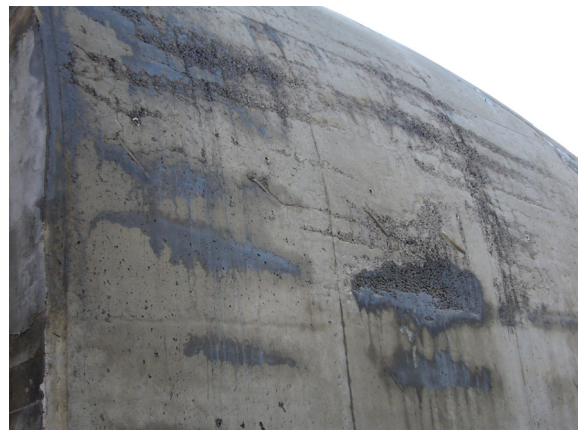
Abb. 2: Tunnelinnenschale aus LP-Beton mit ungünstiger Betonzusammensetzung
