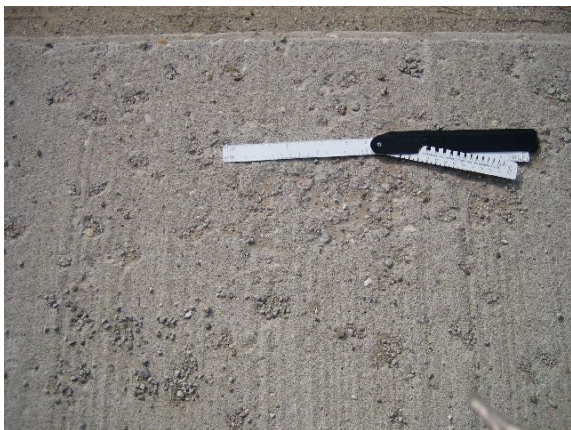
Abb. 1: Typische Abwitterungen an einer Brückenkappe
