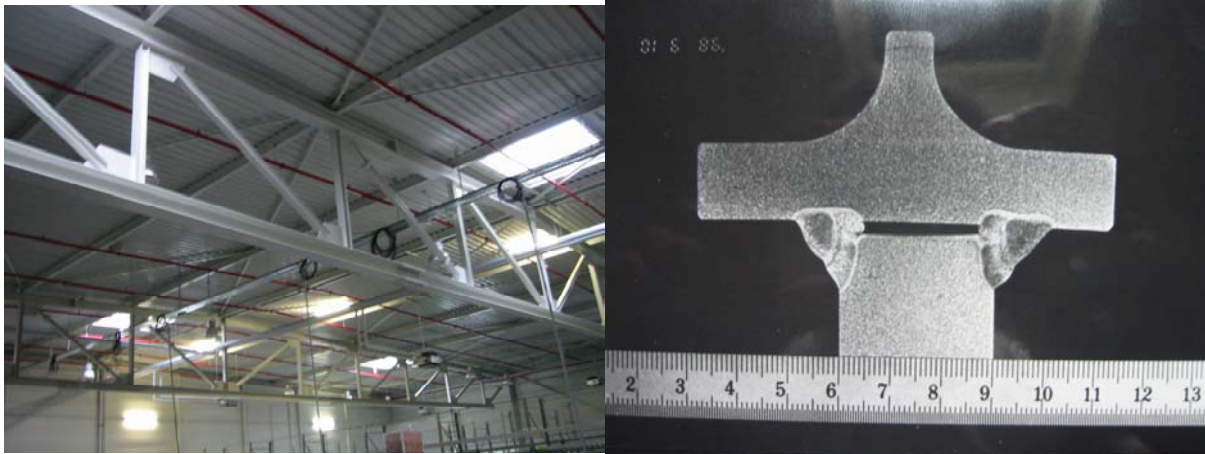
Bild 5.2 Links: Fachwerkkonstruktion mit in die Knotenbleche eingesteckten HE100B-Diagonalen; Rechts: Makroschliff im eingesteckten Querschnitt zeigt Spalt in Querrichtung
