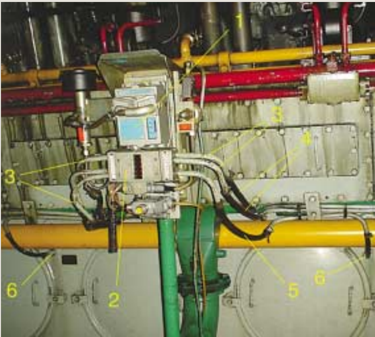
Bild 7: Fehlerhafte Montage eines Ölnebeldetektors VISATRON® VN215 mit Einzelrohrabsaugung zu jedem Compartment zur Selektion des Schadortes 1. VISATRON VN 215 2. Zungenventilbox zur Ansteuerung der Absaugrohre nach einem bestimmten Suchalgorithmus mit Anzeige der Schadstelle (rote Punkte im Anzeigefenster) 3. Einzelabsaugrohre 4. Schlauchverbindungen zwischen den Absaugrohren und den Rohren zur Einführung in die Ventilbox 2 5. U-Bogen im Sampling-System 6. Einführung in das entsprechende Compartment
