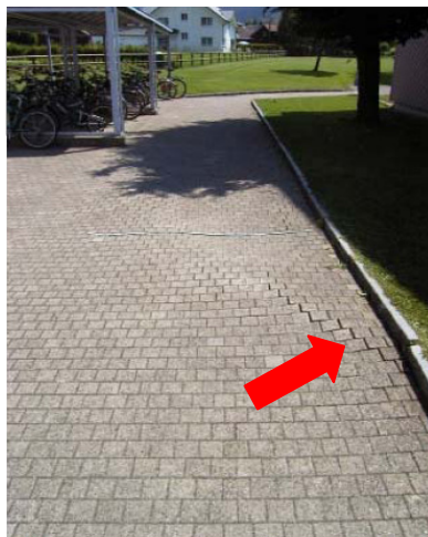
Abb. 2-8: Schadensfälle durch Erdwärmennutzungen: Hebungen und Setzungen infolge einer Vereisung der Zuleitungen (BASSETTI et al. 2005)
