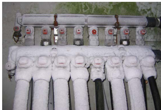
Abb. 2-9: Schadensfälle durch Erdwärmennutzungen: vereister Sondenverteiler (BASSETTI et al. 2005)
