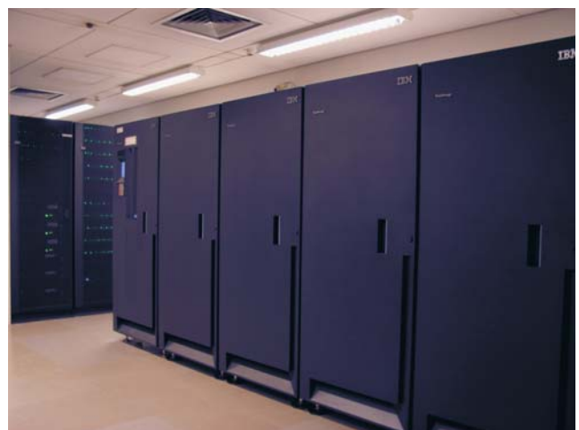
Das neue campusweite Backup-/Archivierungssystem im Untergeschoss des Rechenzentrums.
