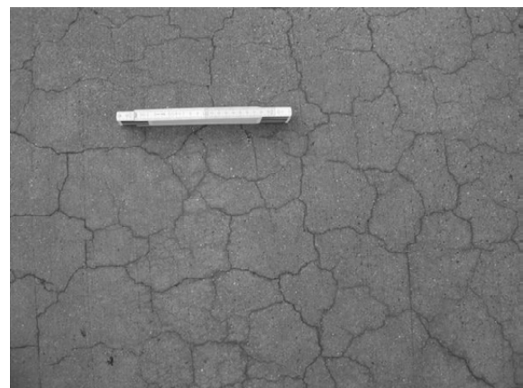
Abb. 30: Grobmaschiges Netz von Rissen infolge Eigenspannungen
