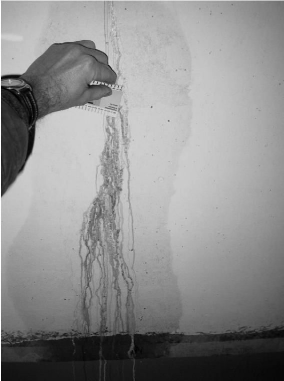
Abb. 14: Beispiel eines wasserführenden Risses; Austritt von Füllgut aus dem Riss; Die Rissfüllmaßnahme war nicht erfolgreich.
