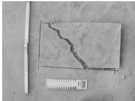
Abb. 34: Trennung einer wenige Millimeter dicken Feinteilschicht vom Kernbereich einer Betonbodenplatte (Stadium einer Probennahme)
