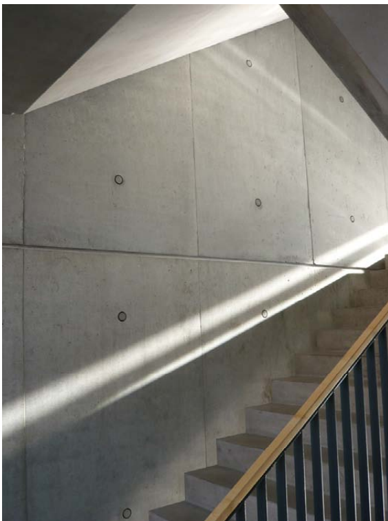
Abb. 1: Repräsentative Sichtbetonfläche mit unauffälligen Rissen (Foto: D. Bosold)
