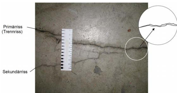
Abb. 6: Streuungen der Rissbreiten entlang von Rissufern
