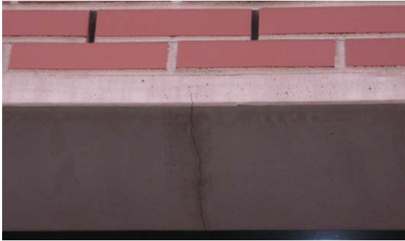
Abb. 2: Biegeriss an Sichtbeton-Fenstersturz
