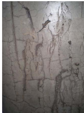
Abb. 1: Krakeleerisse auf Sichtbetonfläche
