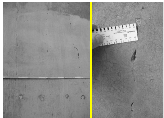
Abb. 37: Rissuferausbrüche infolge einer Biegebeanspruchung der Silowände mit wechselndem Vorzeichen
