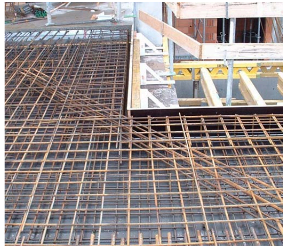
Abb. 4: Zusatzbewehrung in einer einspringenden Ecke (Foto: D. Bosold)
