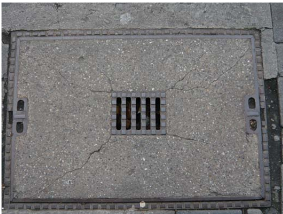
Abb. 3: Eckrisse bei einer Schachtabdeckung (Foto: D. Bosold)
