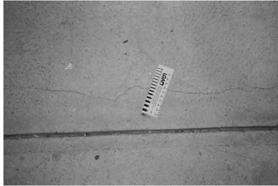
Abb. 21: Beispiel eines Risses unmittelbar neben der „Sollrissstelle“
