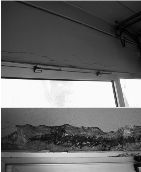
Abb. 44: Foto oben: horizontale Risse in den Betonfertigteilen oberhalb der Fenster. Unten: sichtbar korrodierte Bewehrung nach dem Entfernen des losen Betons
