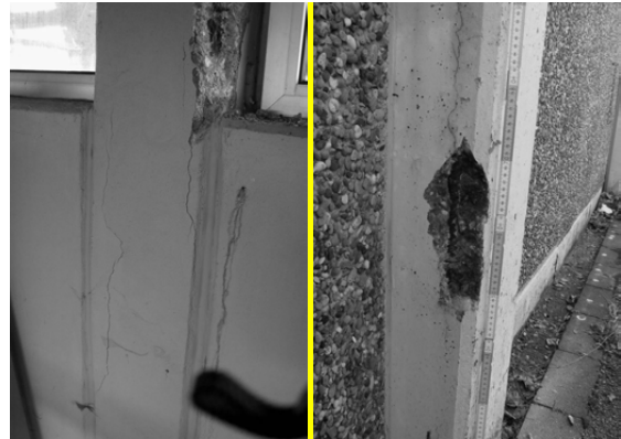
Abb. 45: Links: vertikale Risse entlang der Stützbewehrung infolge von Korrosion der Bewehrung. Rechts: Stützen und Fertigteile an der zugehörigen Wandaußenseite.
