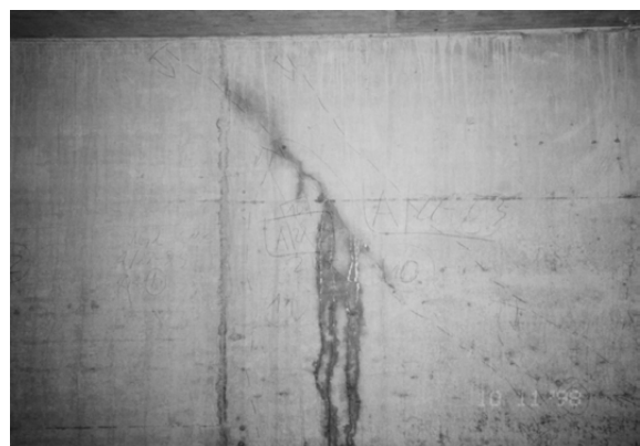
Abb.13: Beispiel eines wasserführenden Risses mit Kalkaussinterung
