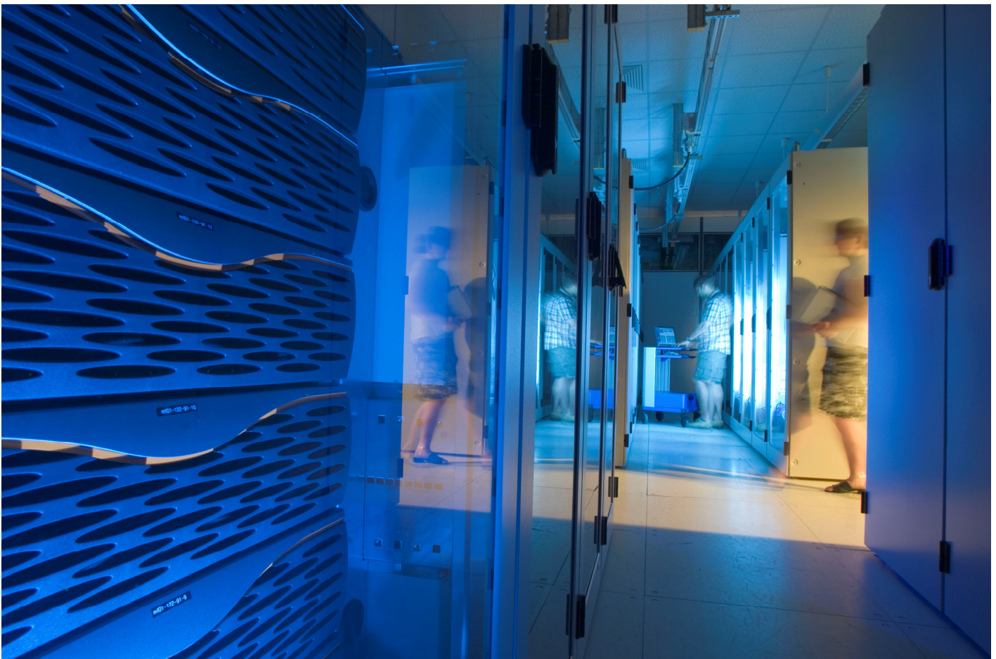
Das am SCC angesiedelte Grid Computing Centre Karlsruhe (GridKa) stellt als eines von elf weltweiten Tier-1-Zentren Rechenleistung und Speicherkapazität für die Teilchenbeschleuniger-Experimente am CERN zur Verfügung.
