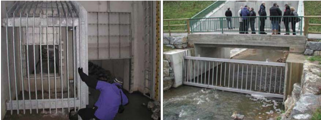
Abbildung 5.1: Links: hochliegender Steuerschieber/Ökoschieber mit Sohlstufe behindert die Durchwanderbarkeit auf der Berme; Rechts: Rechen oberstrom der Anlage ohne durchgängige Uferberme behindert die terrestrische Durchgängigkeit
