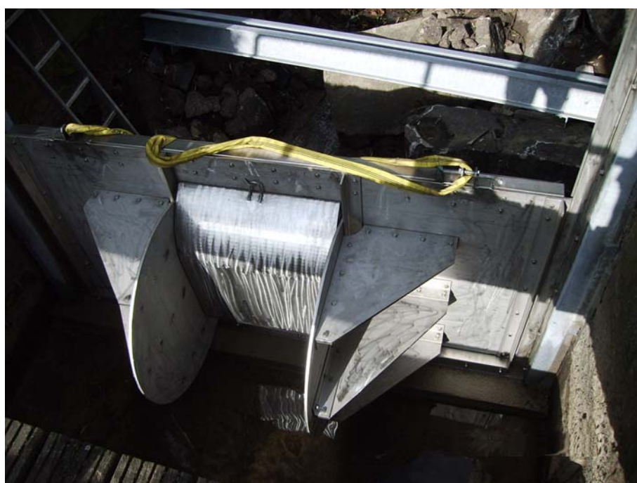
Abbildung D.12: Fertig eingebautes Schütz
