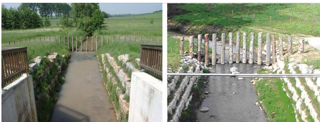
Abbildung 5.7: Palisadenrechen, HRB Raußmühle (links) und HRB Mönchzell (rechts).
