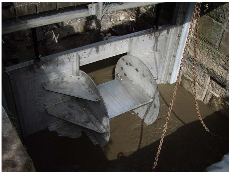
Abbildung D.13: Flutung der Baustelle
