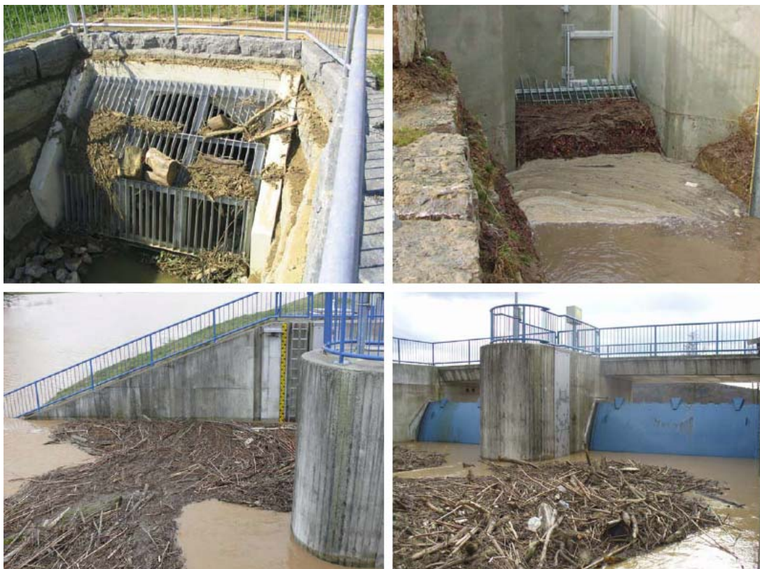
Abbildung 4.52: Geschwemmseltrieb bei Hochwasser [128]
