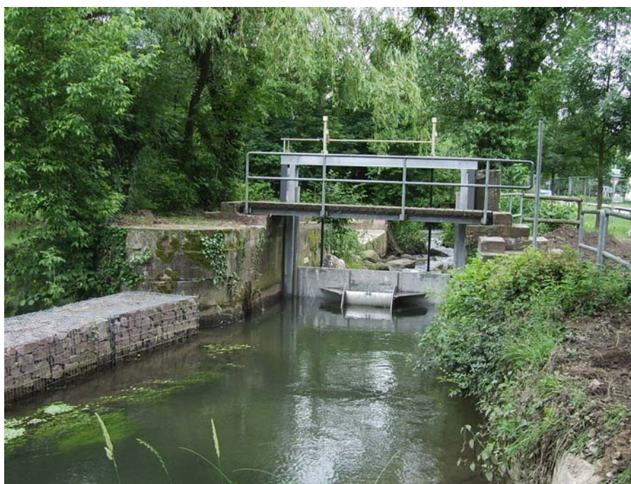
Abbildung D.18: Ansicht des neuen Schützes mit integrierter Schwingklappe, Blick von Oberwasser
