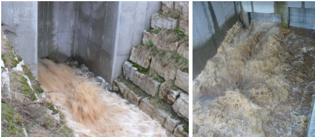
Abbildung 5.12: Abflussgeschehen unterstrom des Durchlassbauwerkes bei Hochwasser, HRB A26 Rittersbach (links), HRB M18 Mönchzell (rechts) [128]
