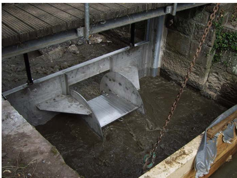
Abbildung D.14: Erster Wasserkontakt der Schwingklappe
