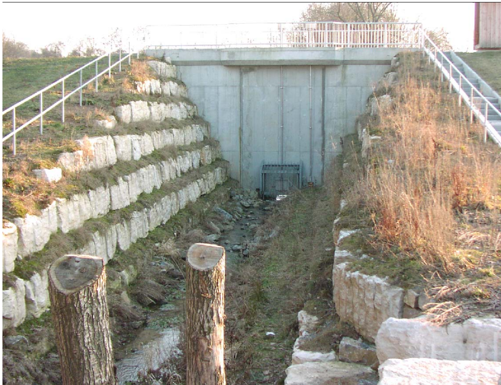
Abbildung 4.64: Durchlassbauwerk des HRB A 26 Aglasterhausen - Rittersbach im Einzugsgebiet Elsenz-Schwarzbach, Blick von Oberstrom.
