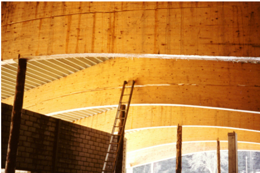
Bild 2-3 Dachtragwerk aus Satteldachbindern mit geneigtem Untergurt, zwei Träger mit Quersugschaden; in diesem Fall und ähnlich gelagerten Fällen wird z.B. der Initialschaden Risse in Faserrichtung nur einmal erfasst, obwohl zwei Bauteile betroffen sind.
