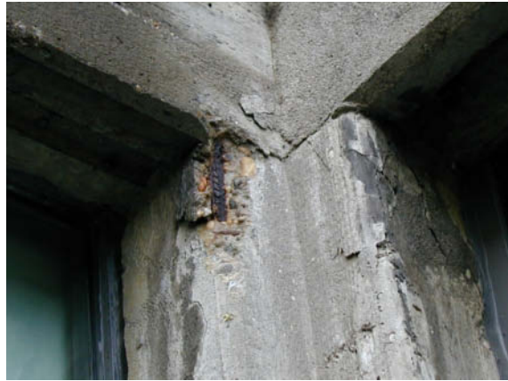
Abb. 11: [B] Einzelne oberflächennahe Bewehrungsstäbe – Abplatzungen des überdeckenden Betons und Korrosion der Stäbe.
