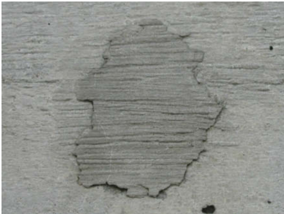
Abb. 15: [F1] Spannanker – Zementplombe gerissen. Keine Stahlkorrosion, da ein Hüllrohr zum Einsatz kam.
