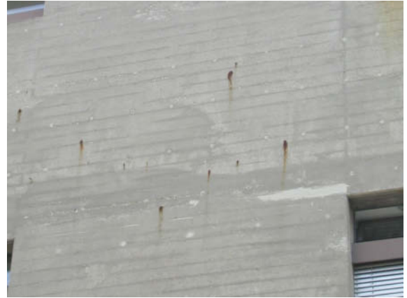
Abb. 18: [H] Vorhandene Reparaturstellen[L] Zuschläge – mit Rostfahnen
