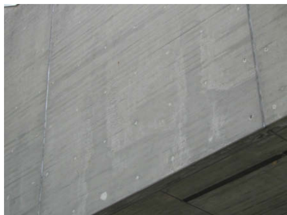
Abb. 13: [D] Entmischungszonen – durch Schüttvorgang verursachte Entmischungen, meist an einzelnen der vertikalen Ortbetonplatten.
