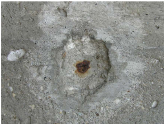
Abb. 16: [F2] Spannanker – Zementplombe gerissen. Feststellbare Stahlkorrosion, da kein Hüllrohr zum Einsatz kam.
