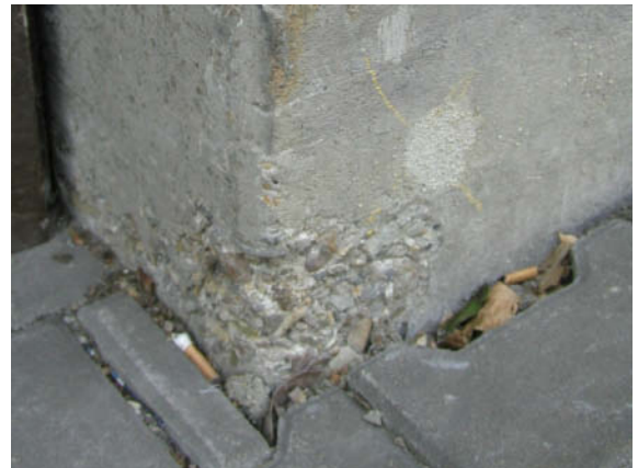
Abb. 19: [J] Chloridinduzierte Beton- und Stahlkorrosion – an einzelnen Sockelbereichen
