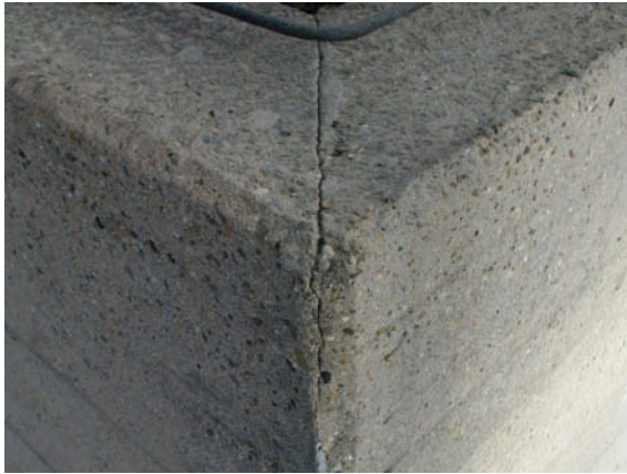
Abb. 14: [E] Eck- und Kantenabrisse – u.a. durch unsachgemäße Bewehrungsausbildung verursacht
