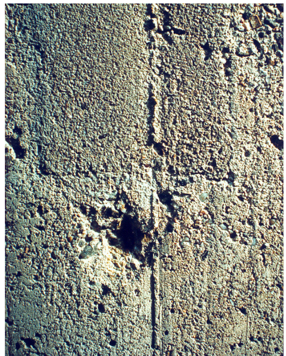
Abb. 8: Detail der instand gesetzten Betonoberfläche des Beethovensaals der Liederhalle Stuttgart (erbaut 1953). Durch Farbgebung des Mörtels, Modellierung der Oberfläche und steinmetzmäßige Bearbeitung angegliche Reprofilierungsstelle (oben) und originale Oberfläche (unten)
