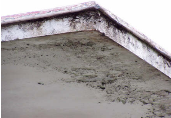
Abb. 4: Sanierung: Burkhardt + Schumacher, Architekten und Ingenieure, Braunschweig, Betonschäden
