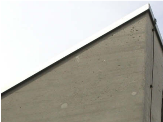
Abb. 12: [C] Stark erhöhte Poren- und Lunkerbildung – Regelmäßig sind die obersten Bereiche der vertikalen Ortbetonplatten betroffen.
