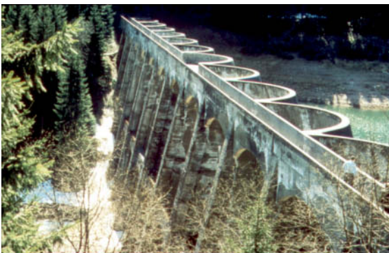
Abb. 1: Abgewitterte Betonoberflächen, Ausblühungen und Rissbildungen an der Linachtalsperre im Südschwarzwald (erbaut 1922 bis 1926). Dauerhaftigkeit und Standsicherheit sind beeinträchtigt
