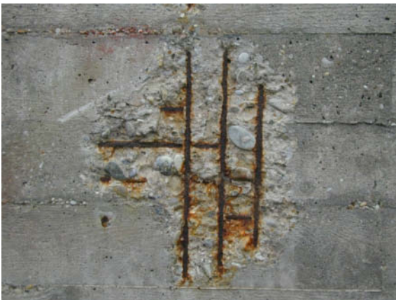
Abb. 10: [A] Minderdeckung – flächenhafte Ausrostung der Schwindbewehrung mit einem Durchmesser von 3 mm bzw. 6 mm in den Obergeschossen und Abplatzung der Betonüberdeckung. Keine Abplatzungen in den Sockelgeschossen.
