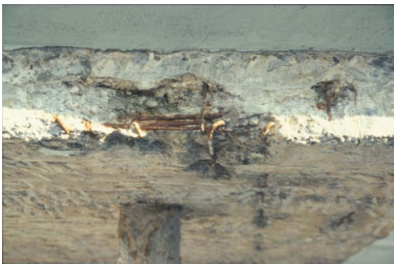
Abb. 2: Sanierung: Architekten 109 Arnold + Fentzloff Stuttgart, Büro für Baukonstruktionen Karlsruhe, Betonschäden
