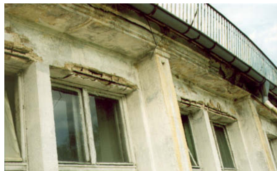
Abb. 2: Korrodierte Bewehrung und abgeplatzte Betonoberflächen am Speisehaus der Nationen (erbaut zur Olympiade 1936 in Berlin)
