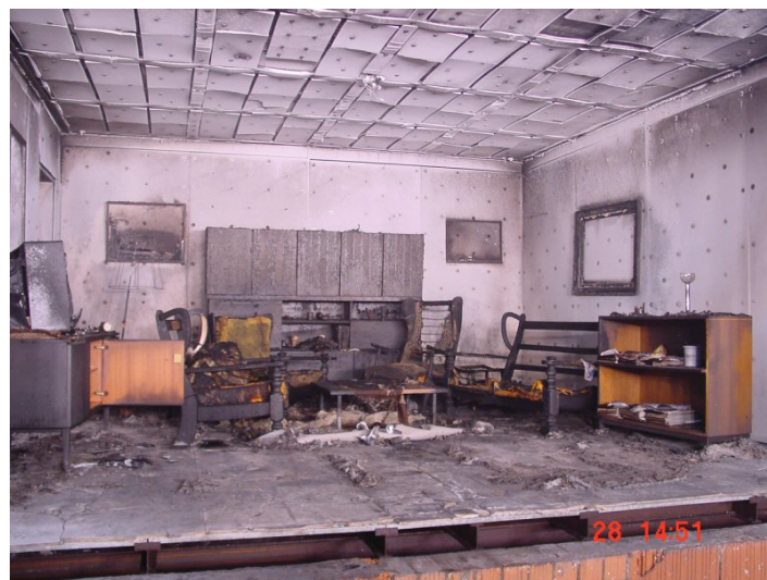
Bild 5-6 Brandraum nach dem Löschen [FFB]
