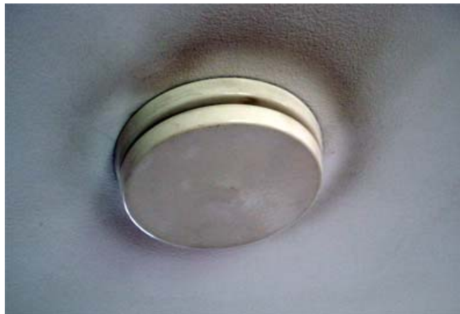
Bild 4-81 Verschmutzter Luftauslass an der Zimmerdecke
