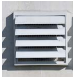
Bild 7-7 Auslass einer Lüftungsanlage [www.architec24.de]
