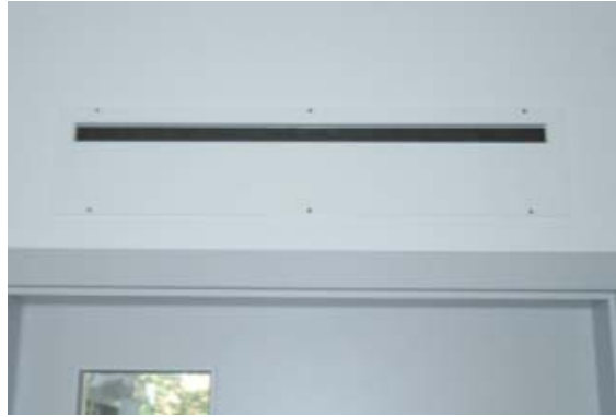
Bild 4-3 Überströmöffnung oberhalb einer Tür [www.zukunft-haus.info]
