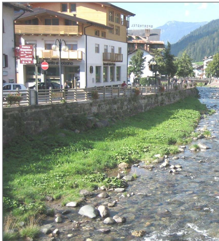
Abbildung 25: Das unmittelbar angrenzende Umland wird anthropogen genutzt, die Uferböschung ist verbaut. Ein naturnah strukturierter Böschungsfuß erhöht die Strukturvielfalt (Avisio in Moena )
