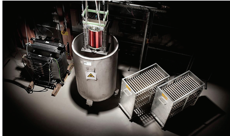
Abb. 5.6: Messaufbau für Transformator-Messungen. Links: Speisende Quelle (400 kVA Transformator). Mitte: Offener Dewar mit supraleitendem Transformator (abgehängt). Rechts: Leistungswiderstände für die Belastung des Transformators.
