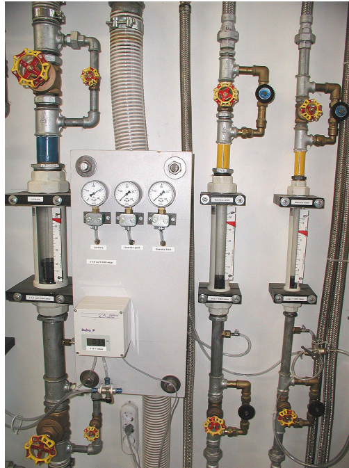
Abb. 6.10: Durchflussmessgeräte zur Volumenstrombestimmung der Brenngas- und Luftversorgung
