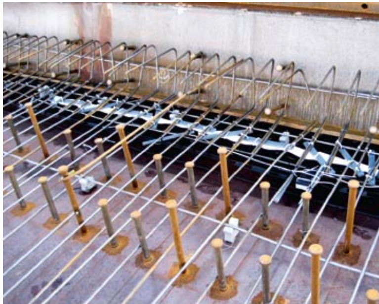
Angriff von innen: Feuchtigkeit verkürzt die Lebenszeit von Brücken und Bauwerken.
