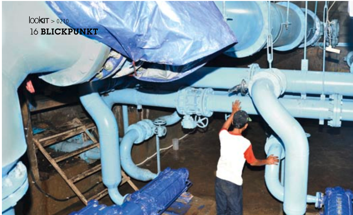
Pilotprojekt: Eine Förderanlage versorgt künftig 75.000 Menschen mit bis zu 60 Litern Wasser am Tag.
