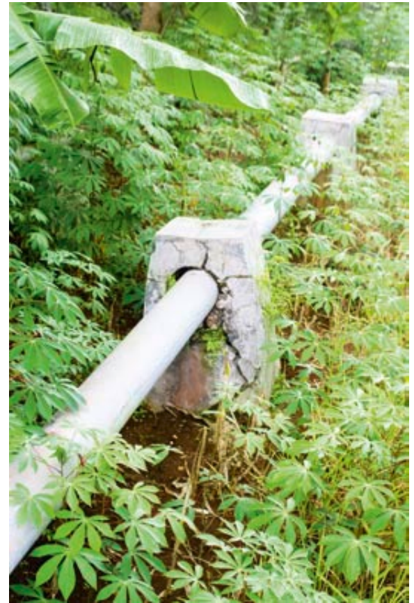
Marodes System: Viele Leitungen in der Gunung Kidul sind schadhaft.
