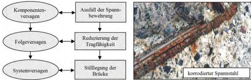
Bild 5. Ausfalleffektanalyse am Beispiel einer korrodierten Spannbewehrung
