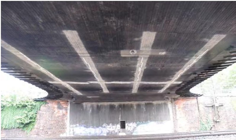
Bild 2 Untersicht der Unionbrücke in Offenburg während der vorbereitenden Arbeiten zur Applikation der Rissüberwachung (Sensorpositionen liegen in den hellen Bereichen)
