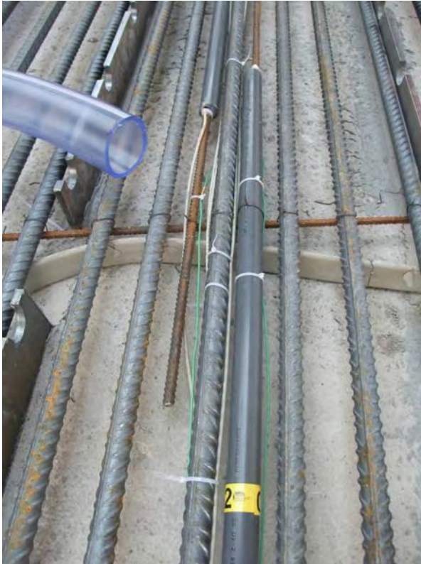
Bild 3 Dehnungsmessstellen an der Unionbrücke in Offenburg
