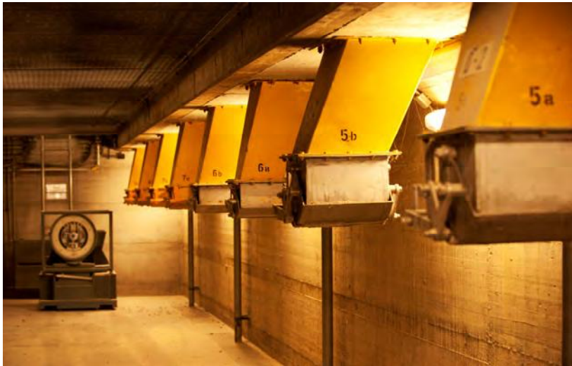
Bild 6 Siloanlage im Untergeschoss der Versuchshalle
