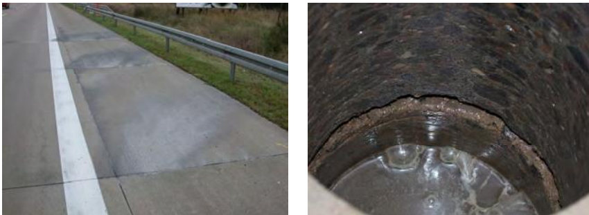
Bild 1 Ablagerungen auf dem Standstreifen - Hinweis auf eine Erosion der Tragschicht (links) und erodierte Tragschicht (rechts)
