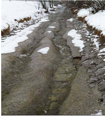
Bild A-2.7: Verschleißschäden in einem Bachbett aus Beton [110]
