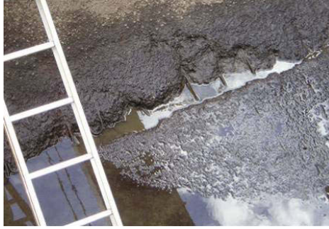
Bild A-2.4: Verschleißschäden an einer Betonsohle einer Schleuse (Mittelhaupt), (eig. Foto)
