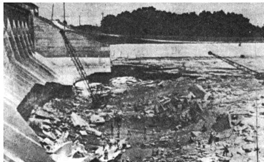
Bild A-2.9: Verschleißschäden im Tosbecken des Lake Waco Dammes, Texas, USA [109]
