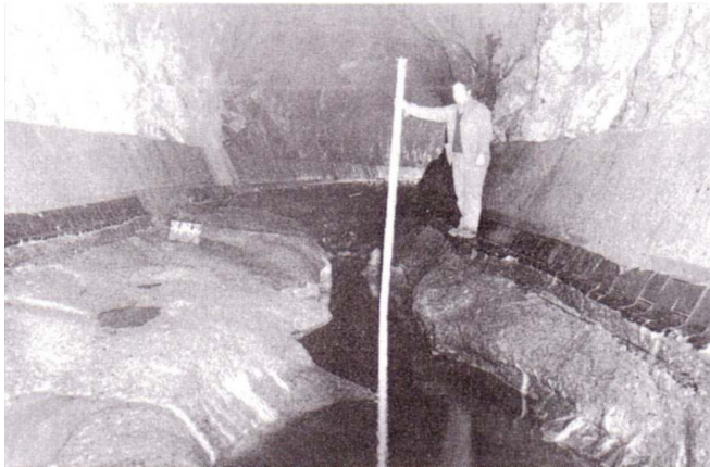
Bild A-2.3: Verschleißschädigung des Betonbodens eines Umleitstollens [34]
