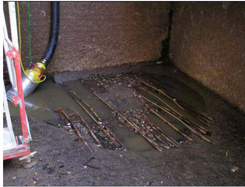
Bild A-2.5: Verschleißschäden an einer Betonsohle einer Schleuse (Vorboden), (eig. Foto)
