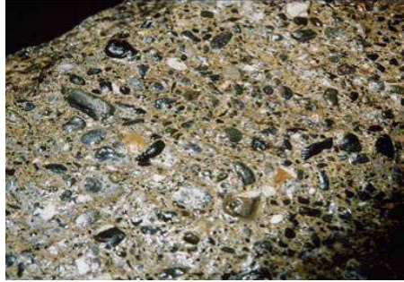
Bild A-2.1: Verschleißschädigung einer Wehrkrone mit freigelegtem Gesteinskorn [111]
