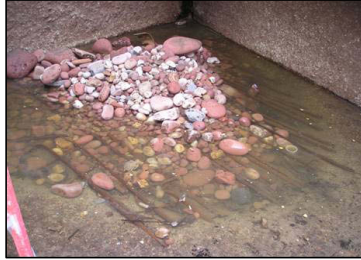
Bild 5.5: Infolge hydroabrasiver Beanspruchung freigelegte und beschädigte Bewehrung einer Bodenplatte (hier: Schleuse)
