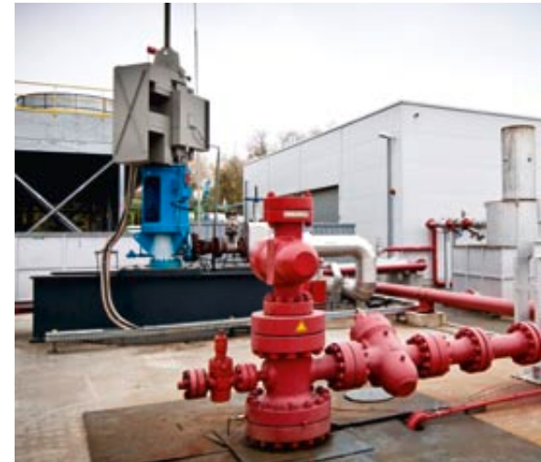
Prototyp: das Geothermie-Kraftwerk in Landau.
