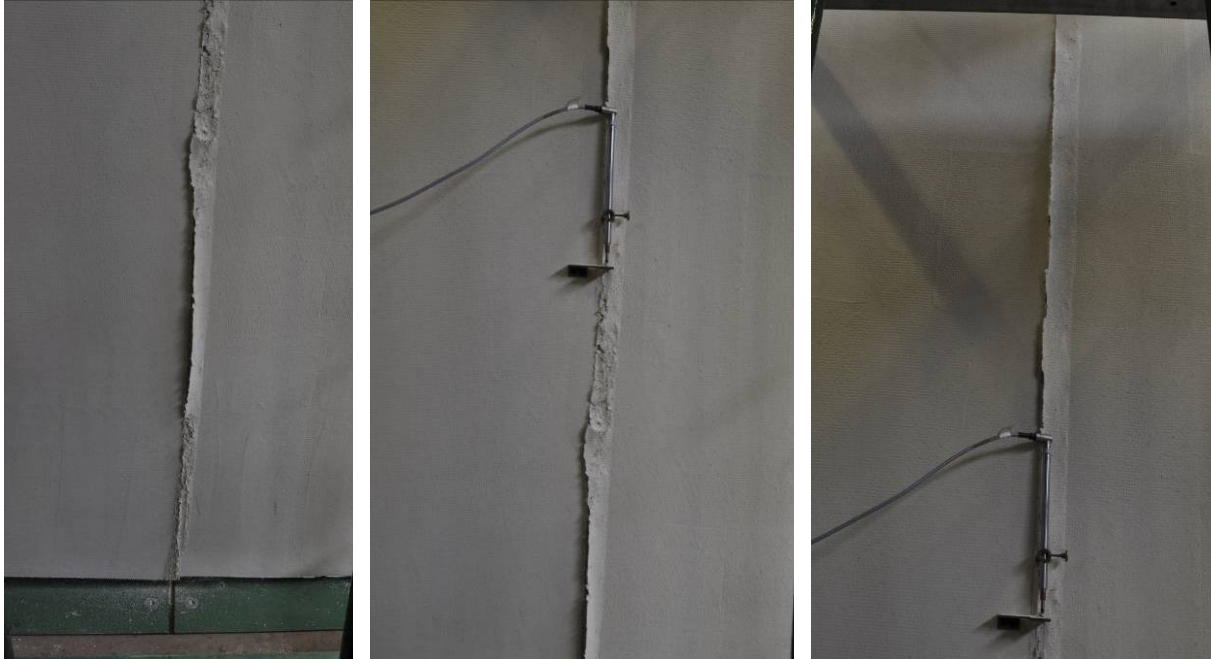
Bild 12-17 Riss im Putzsystem an der Stelle der Verbindung der Tafелеlemente
