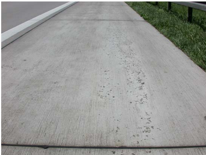
Bild 45: Zustand der Fahrbahndecke im Bereich der Entnahmestelle des Bohrkerens Nr. 23, Zeitraum nach der Herstellung bzw. Nutzungsdauer: 5 Jahre Abwitterung ca. 50 ... 150 g/m 2
