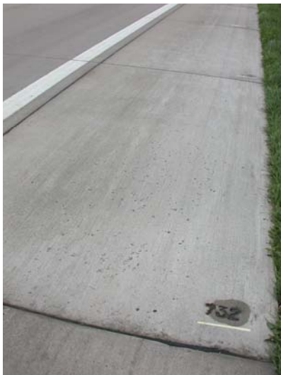
Bild 47: Zustand der Fahrbahndecke im Bereich der Entnahmestelle des Bohrkerns Nr. 24, Zeitraum nach der Herstellung bzw. Nutzungsdauer: 5 Jahre Abwitterung ca. 50 ... 150 g/m 2
