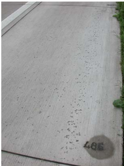
Bild 43: Zustand der Fahrbahndecke im Bereich der Entnahmestelle des Bohrkerns Nr. 22, Zeitraum nach der Herstellung bzw. Nutzungsdauer: 5 Jahre Abwitterung ca. 50 ... 150 g/m 2
