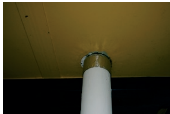
Abb. 2.28 Haus Wolters, Fallrohr Entwässerung
