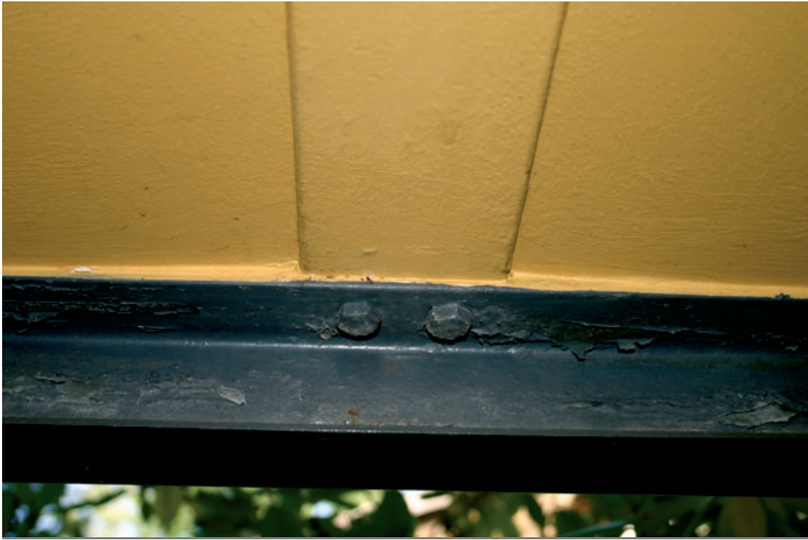
Abb. 4.02 Haus Wolters, korrodierte Stellen am Bodenrost
