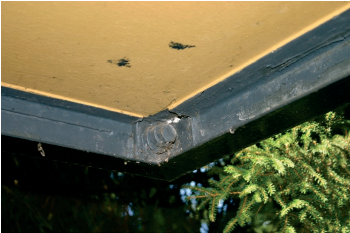
Abb. 4.03 Haus Wolters, korrodierte Stellen am Bodenrost
