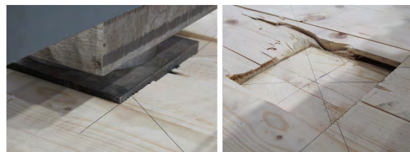
Abb. 11 Lokales Querdruckversagen im Lasteinleitungsbereich
