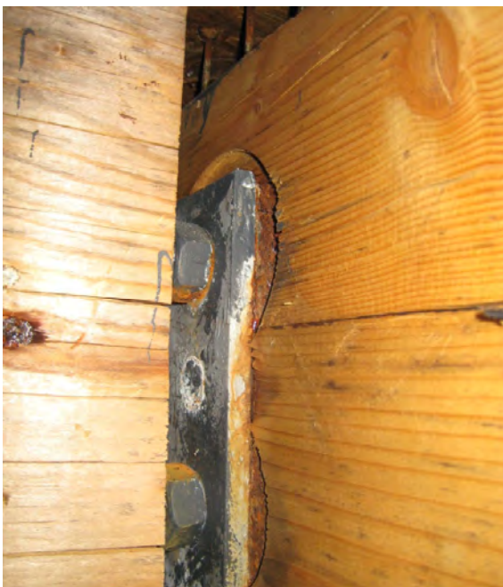
Abb. 4 Korrosionsschäden am Anschluss des auskragenden Dachrandes
