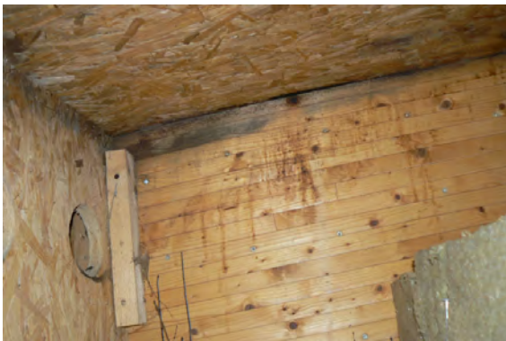
Abb. 3 ältere, bereits getrocknete Wasserflecken an der Holzkonstruktion erkennbar
