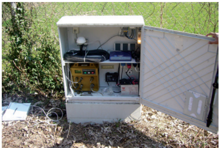
Abb. 1 – Typische Schaltanlage einer seismischen Station im Oberrheingraben
