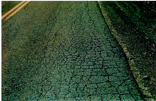
(a) Elefantenhaut, „Alligator cracking“
