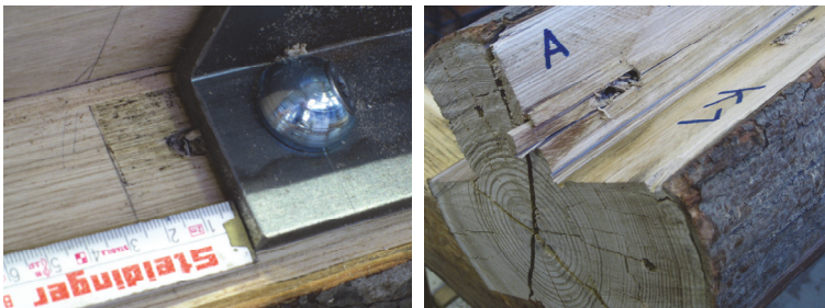
Bild 3-11 Relativverschiebung zwischen Holz und Stahlwinkel (links) und lokale Zerstörung des Holzes im sichtbaren Bereich des Schraubkanals (rechts)
