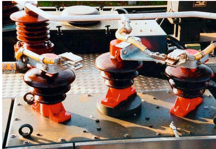
Abbildung 95: Umschalter auf dem Wagendach eines Zweisystem-Stadtbahnwagens 2271
