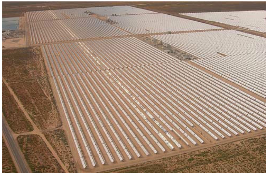
Abb. 4: Solarthermisches Kraftwerk in Al Kuraymat, Ägypten, 2010 Quelle: www.protermosolar.com/boletines/32/d05.html
