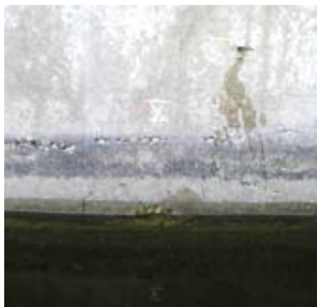
Kritisch: schadhafte Stellen im Beton am Wasserkraftwerk Woschskaja bei Wolgograd.
