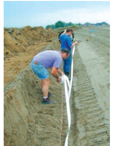
Ein Kabelsensor überwacht künftig in diesem Hochwasserdeich den Wassergehalt und damit die Stabilität des Deichs
