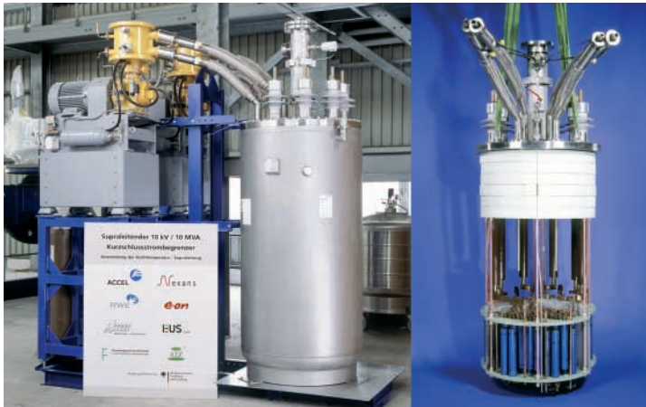
Der Kurzschlussstrombegrenzer CURL10 bestand den weltweit ersten Feldtest von April 2004 bis März 2005 im Netz der RWE bei Siegen
