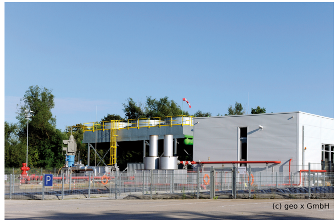
Bild 2. Das Geothermie-Kraftwerk in Landau. Am linken Bildrand befinden sich die Bohrköpfe (in rot und blau). Im Hintergrund links neben der Pumpenhalle befinden sich die Kühler für die Kondensation des Arbeitsmediums nach der Stromerzeugung. Im Vordergrund ist die Einzäunung der Rückhaltebecken zu erkennen. Mit freundlicher Genehmigung der geo x GmbH © geo x GmbH.
